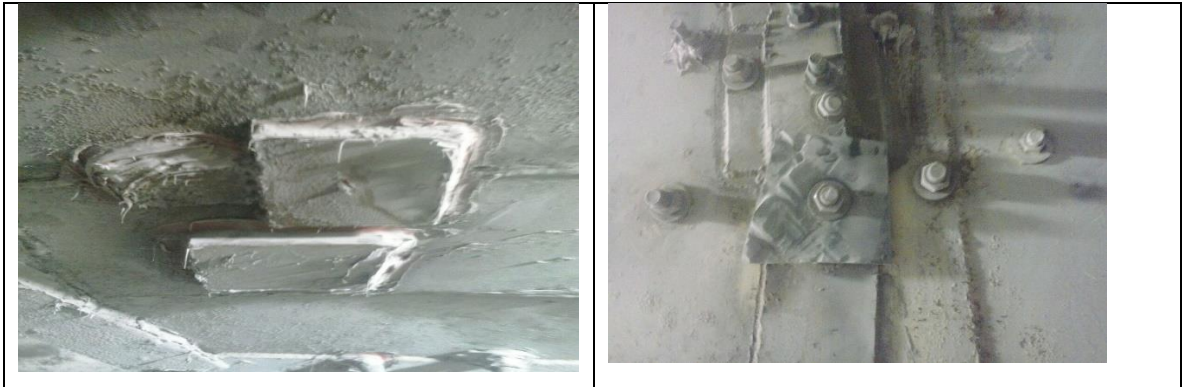
Figura 25. Tolva mal hermetizada
