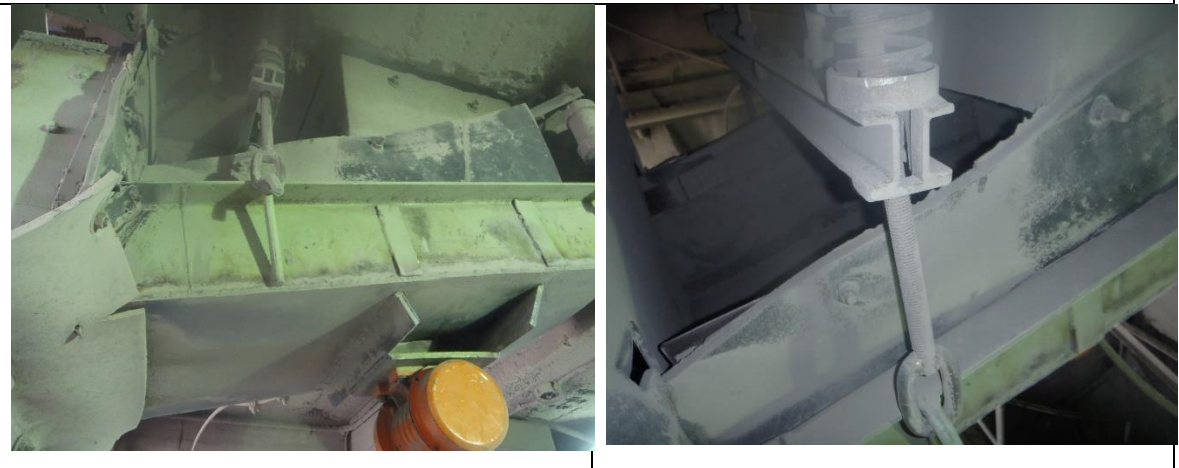
Figura 21. Bajante de material grueso
