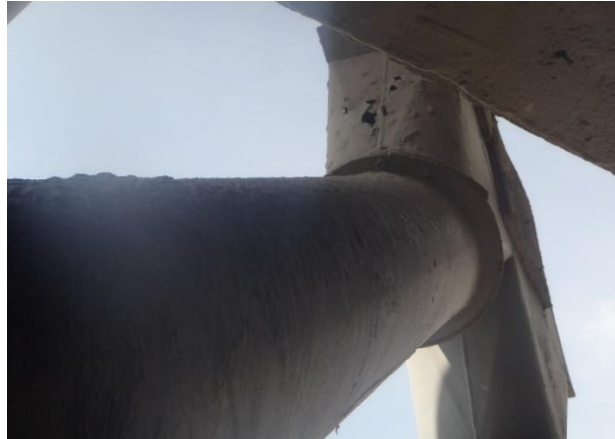
Figura 22. Codo con fisuras.
