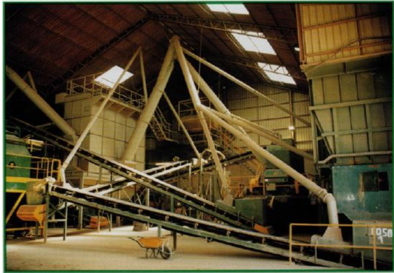
Fuente: GORCO. Filtros de mangas transporte neumático
