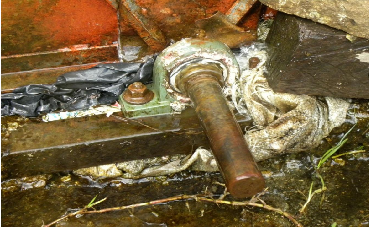
Agua que sale de el generador de energia despues del proceso
