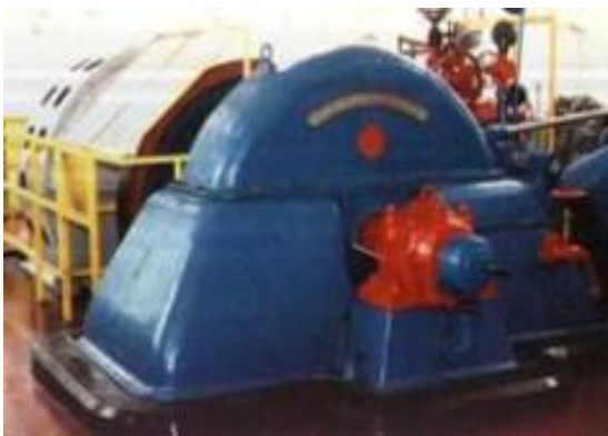
Fotografía 3. Turbina PELTON y alternador
