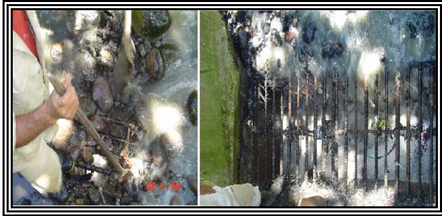
Foto 37. Rejilla de captación de aguas servidas quebrada la Chocoita
