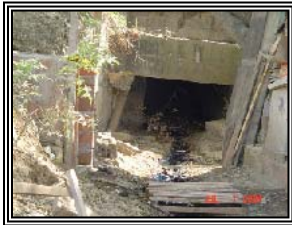
Foto 29. Box culvert contaminado por las aguas negras de Soserautos
