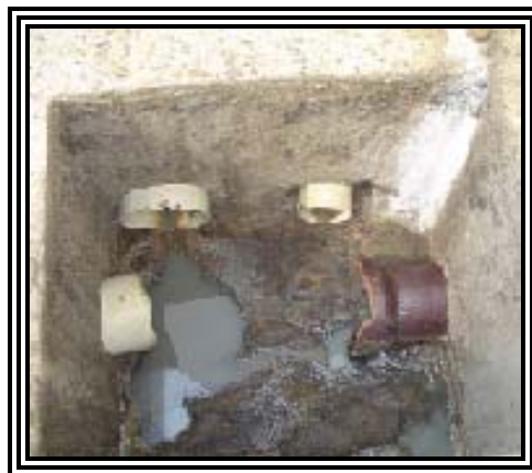
Foto 19. Caja de aguas lluvias de Aceygrades
