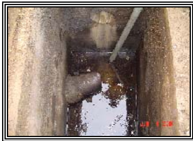
Foto 23. Caja de aguas lluvias de OTACC.
