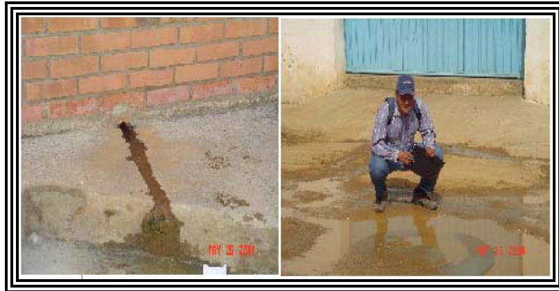
Foto 15. Acumulación de agua en la cra 12
