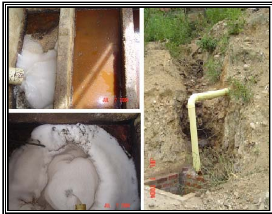
Foto 13. Sistema de tratamiento de grasas de la empresa Aceygrades Ltda. descargando directamente al cauce.
