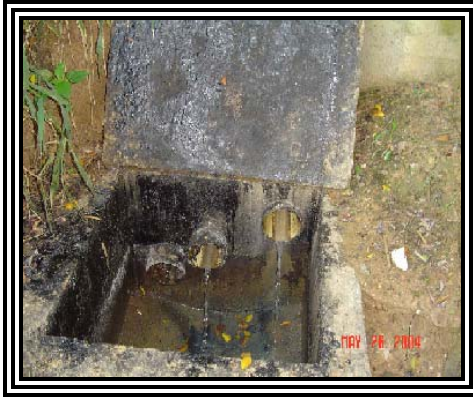
Foto 27. Caja donde se unen las aguas negras con las aguas lluvias. Itacol
