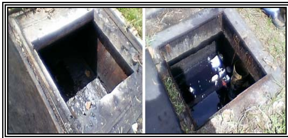
Foto 41. Trampas de grasas estación de servicios Terminal de transportes.
