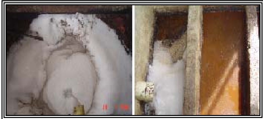
Foto20. Trampa de grasas de Aceygrades
