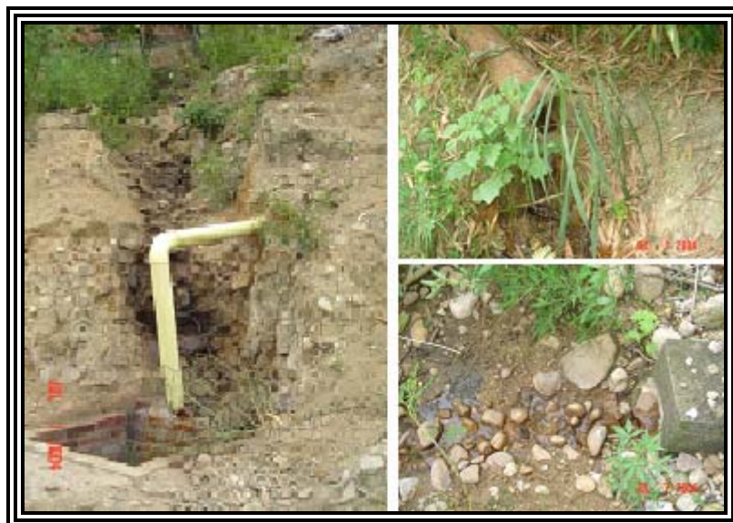
Foto 8. Descargas directas de aguas servidas a los taludes que bordean el canal de la Quebrada
