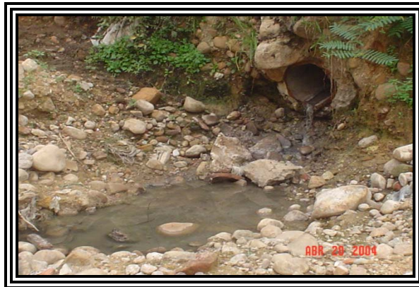
Foto 9. Descarga contaminante proveniente de Aceygrades.
