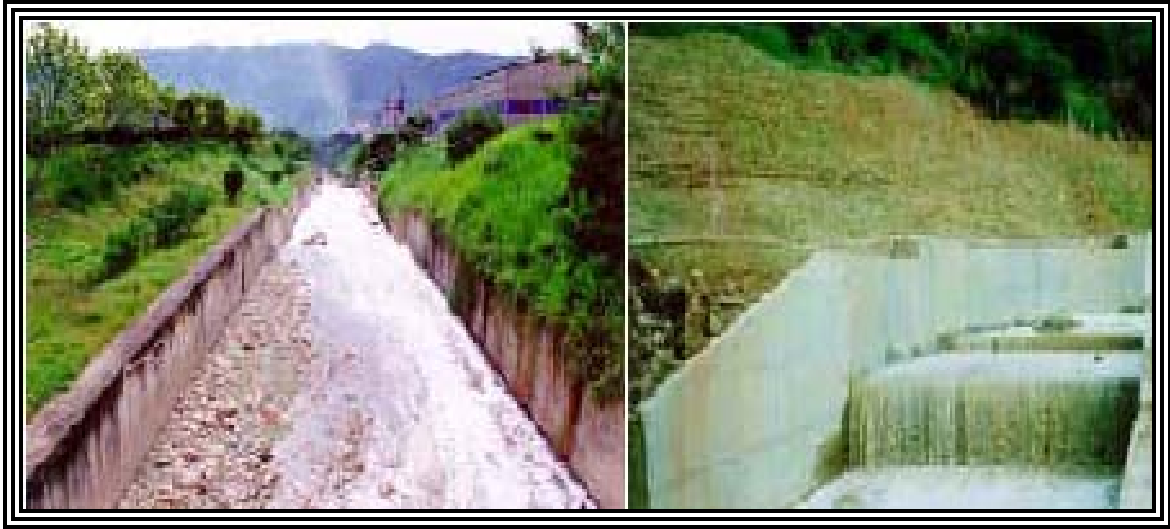
Foto 6. Estado actual canalización de la Quebrada La Iglesia.
