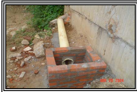
Foto 12. Tubería conectada a caja de inspección Agribor S.A.
