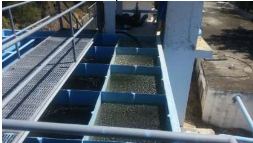
Figura 16. Módulos de floculación tipo alabama
