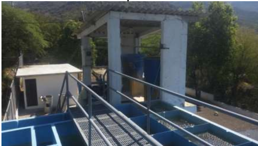
Figura 13. Caseta de dosificación de químicos
