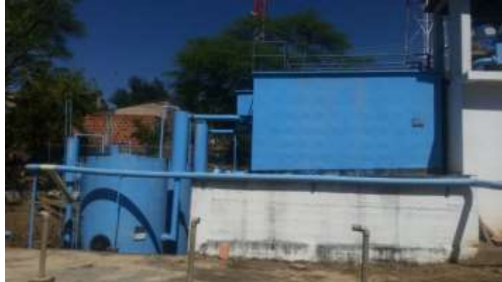
Figura 10. Imagen general de la Planta de tratamiento de Capitanejo
