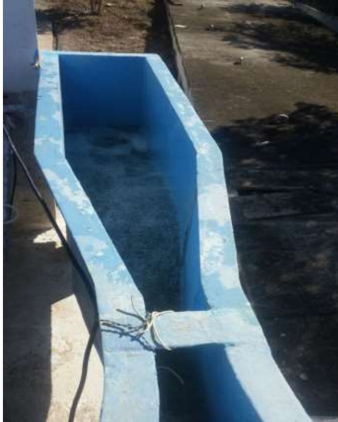
Figura 11. Entrada de agua cruda a canaleta Parshall
