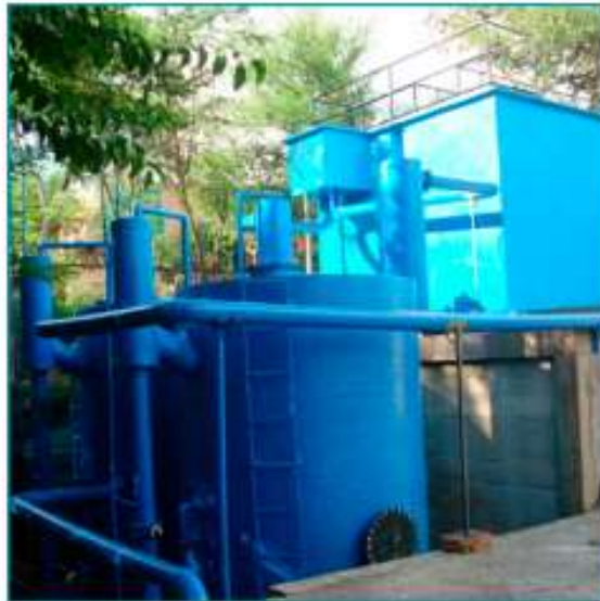
Figura 5. Planta de tratamiento de agua potable Capitanejo Año 2004
