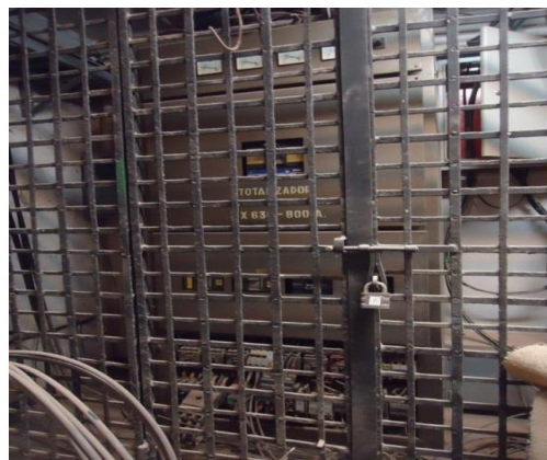
Figura 85. Equipos de protección Eléctrica (Breakers) , subestación Bucarica
