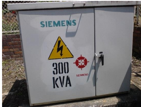
Figura 2. Transformador Tipo Pedestal Sede Barbosa.
