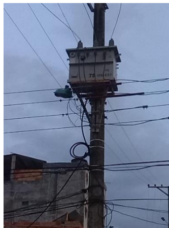
Figura 3. Transformador Tipo Poste. Sede Socorro
