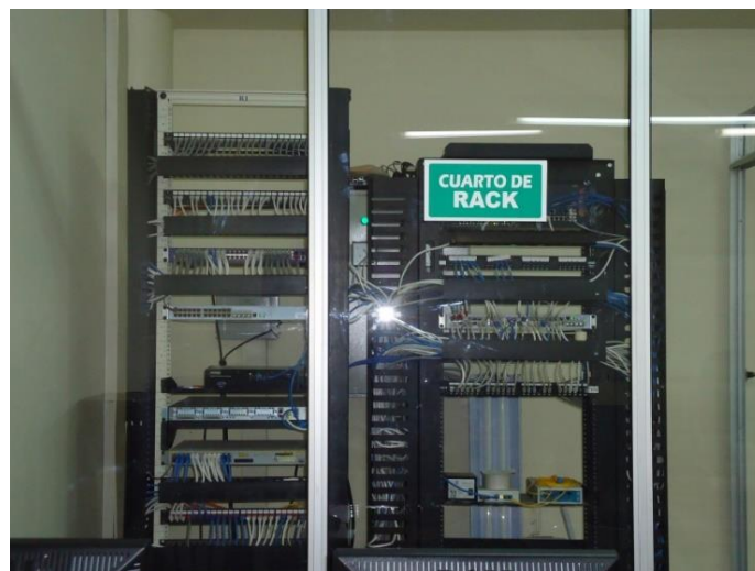
Figura 30. Cuarto de RACK – Sede Málaga
