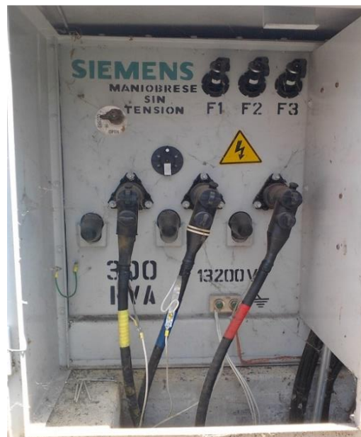
Figura 65. Transformador 300 kVA, Subestación BARBOSA.
