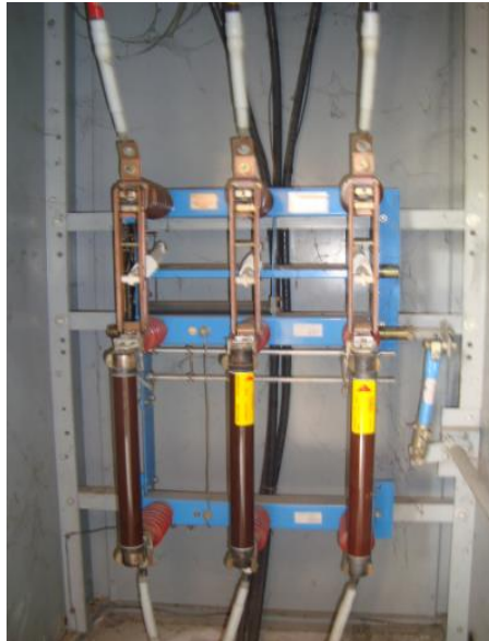
Figura 4. Seccionador. Sede Barrancabermeja Fuente Autor
