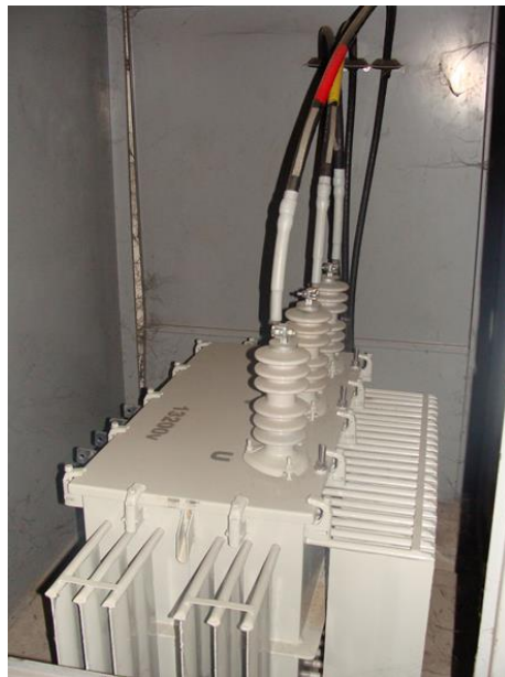
Figura 1. Transformador Convencional Sede Barrancabermeja
