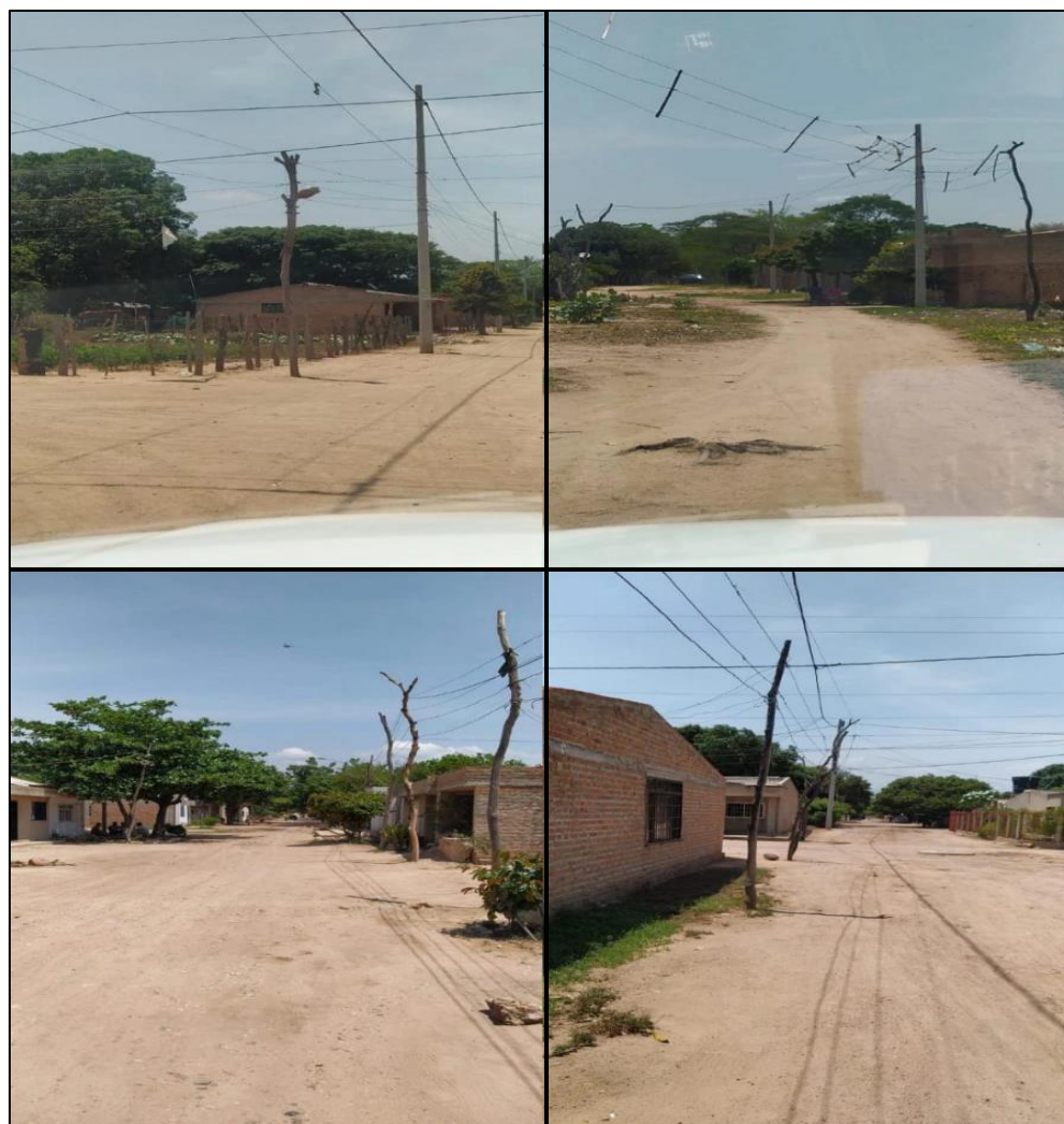
Figura 3. Fotografía proyecto: estructuras de apoyo improvisadas por la comunidad.
