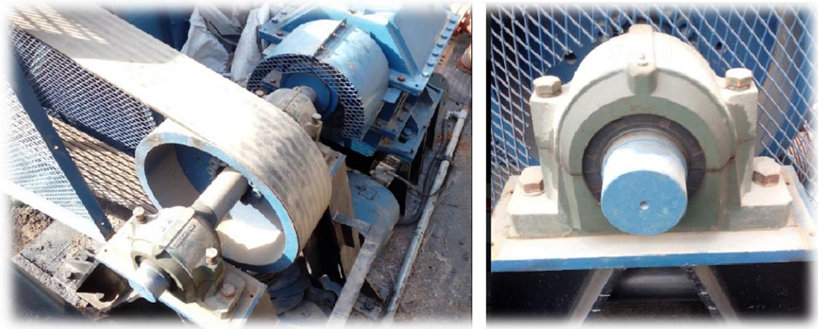
Figura 59. Chumaceras acopladas en el equipo de bombeo industrial.
