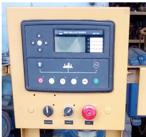
Figura 50. Tablero de control de arranque del motor.
