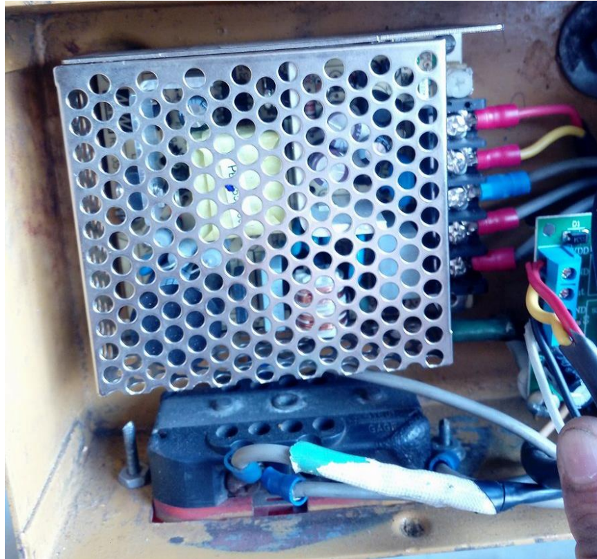
Figura 47. Convertidor de voltaje alterno de 110 V. a voltaje continuo de 12 V.
