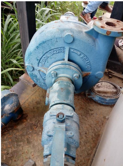
Figura 30. Bomba centrífuga principal
