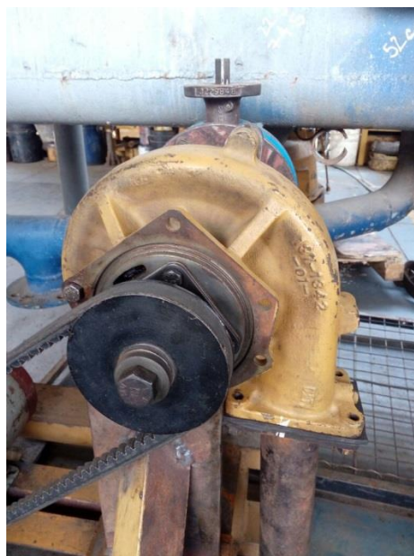
Figura 31. Bomba centrífuga secundaria.
