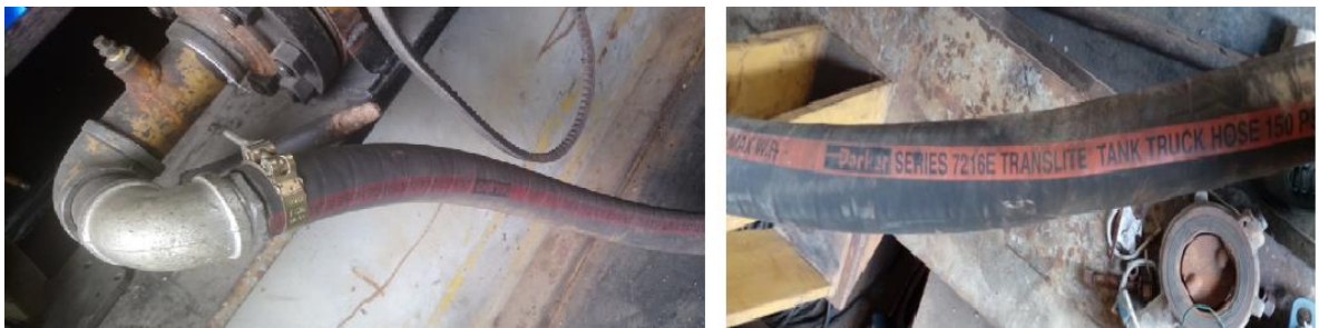
Figura 33. Línea del circuito hidráulico
