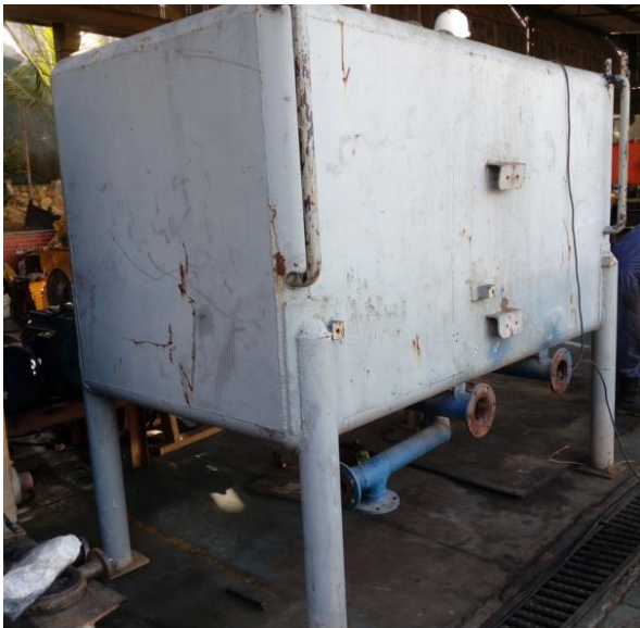
Figura 32. Tanque de almacenamiento
