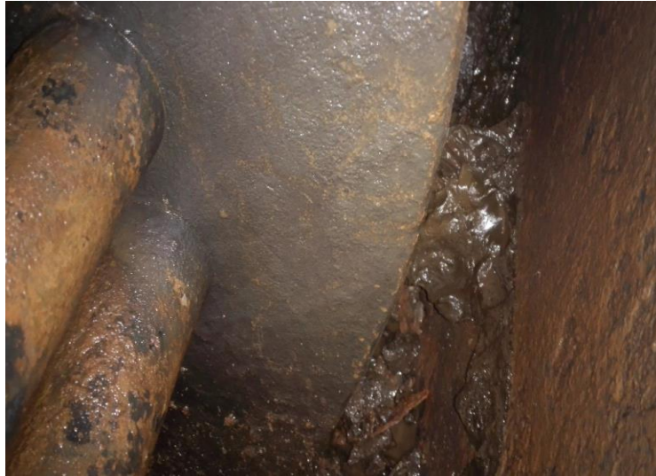
Figura 18. Estado de los tubos lado agua caldera
