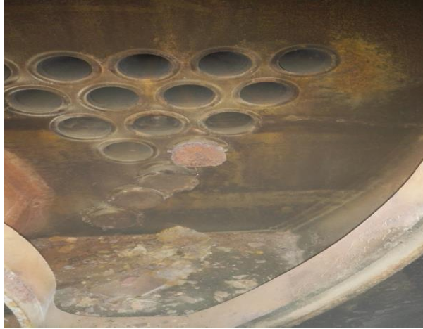
Figura 16. Tubos condenados caldera
