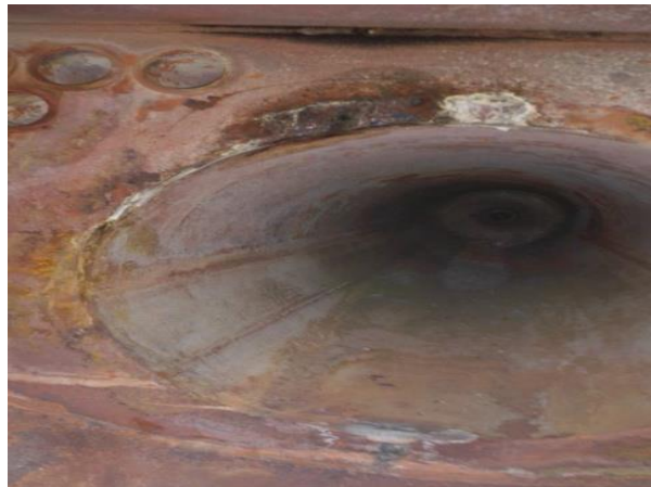
Figura 17. Fuga placa tubos caldera
