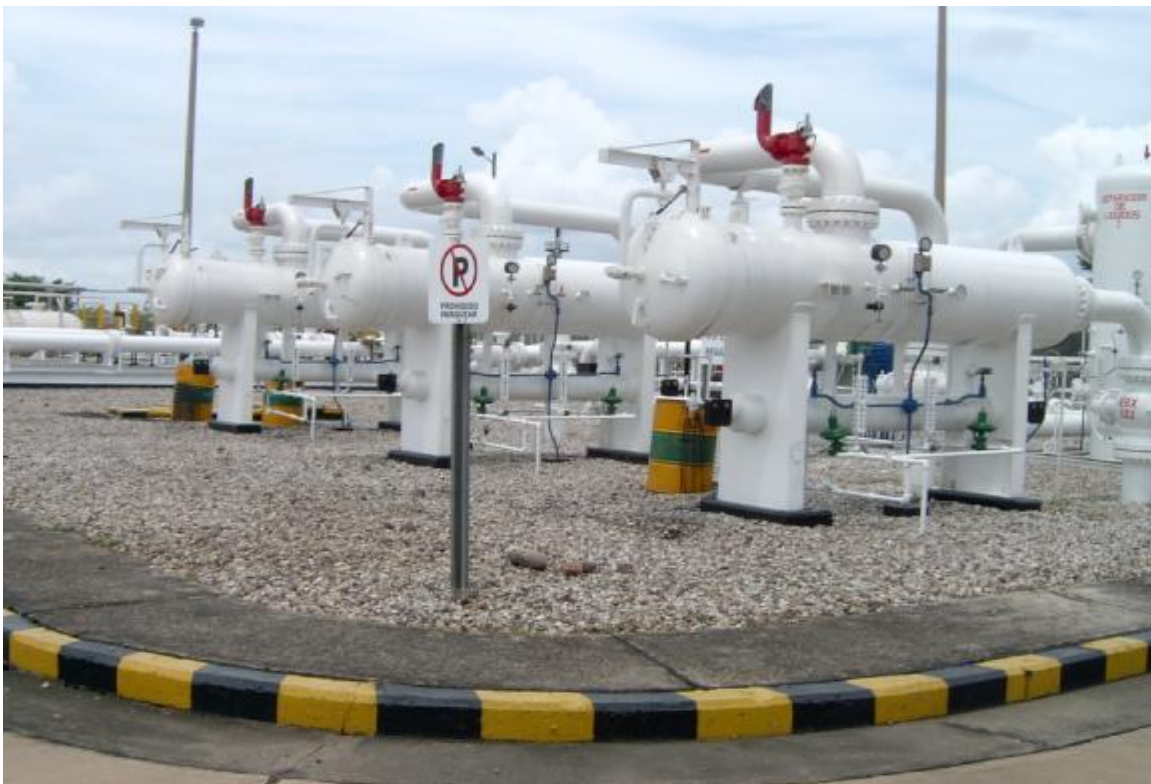
Fotografía 2. Sistema de filtración de la Estación Barrancabermeja
