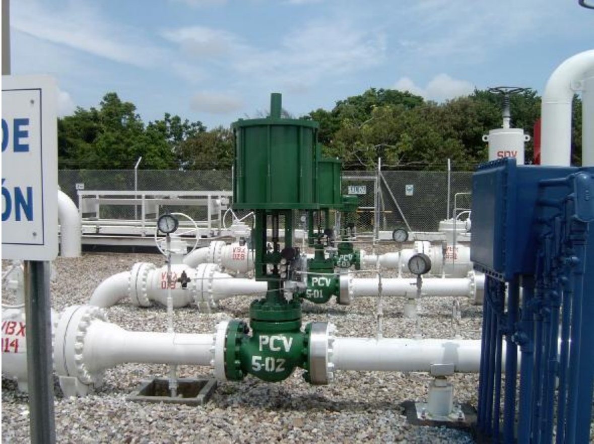
Fotografía 3. Sistema de regulación de la Estación Barrancabermeja.
