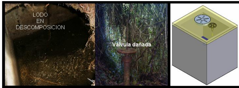
Ilustración 17. Tanque de captación que tiene la válvula dañada
