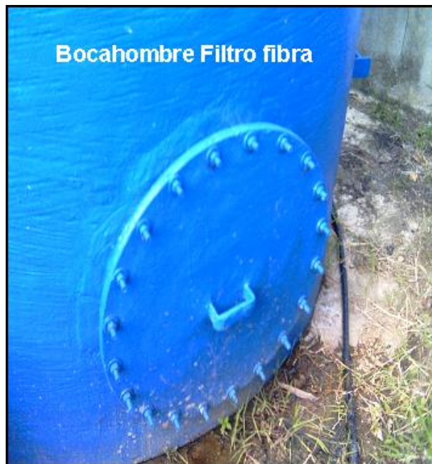
Ilustración 23. Compuerta filtro fibra
