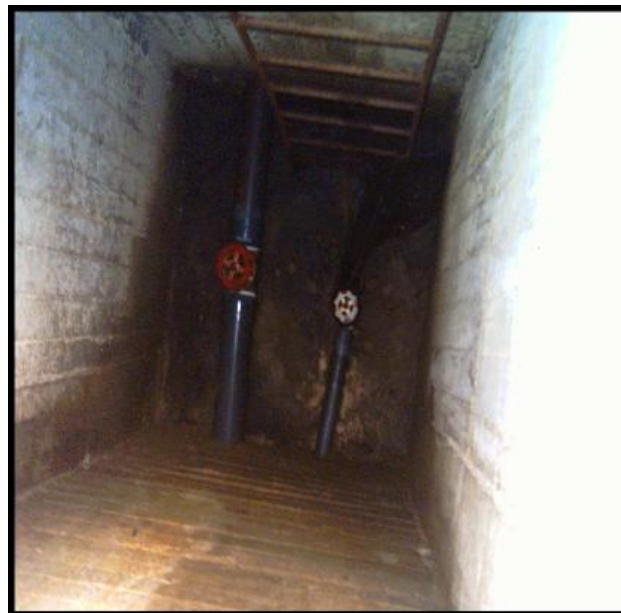
Ilustración 28. Válvula de lavado tanque almacenamiento
