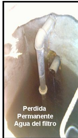
Ilustración 24. Salida agua retrolavado
