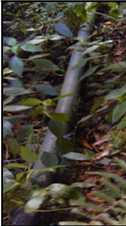
Ilustración 6. Tubería de conducción hasta la planta.
