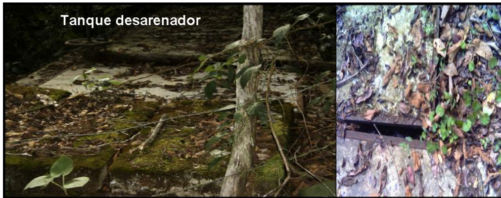
Ilustración 20. Tapas tanque desarenador
