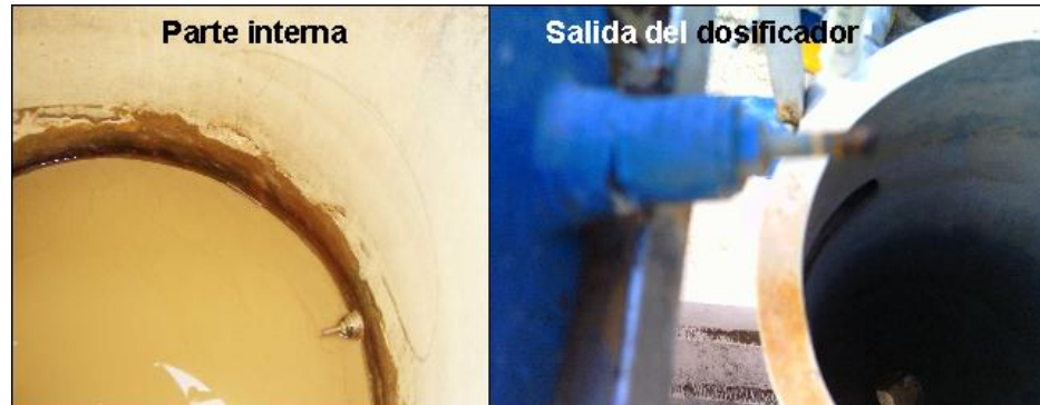
Ilustración 21 sistema de dosificación actual
