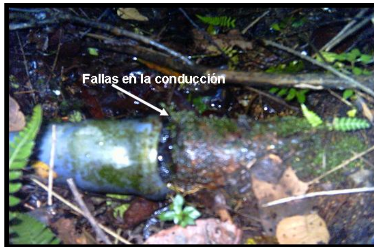
Ilustración 18. Fallas sistema de conducción
