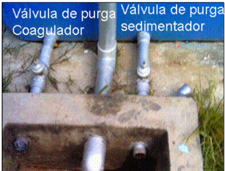
Ilustración 12. Válvulas de purga en mal estado
