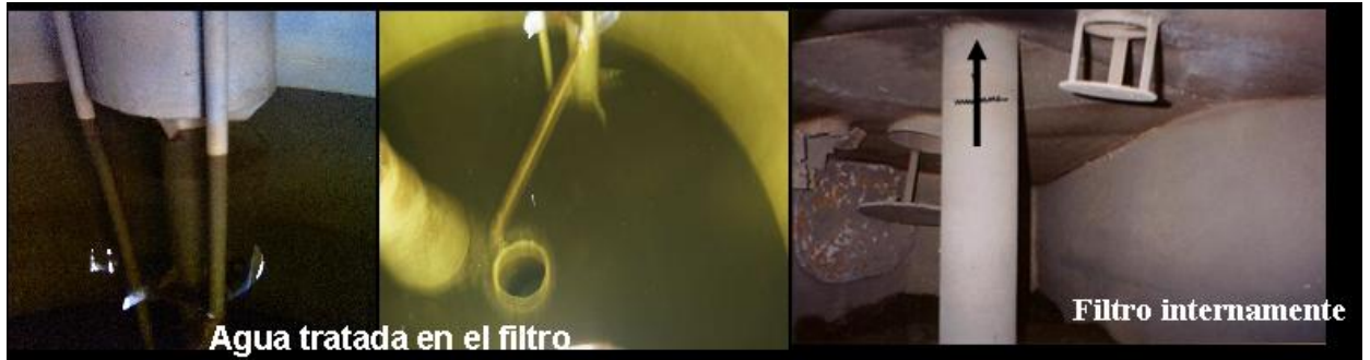
Ilustración 26. Sistema de filtración.
