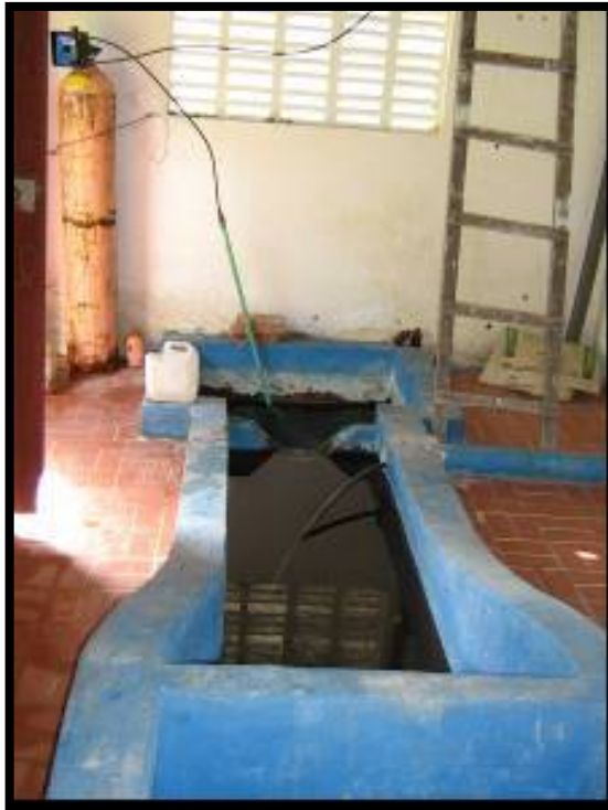
Ilustración 27. Cloro gaseoso tanque de almacenamiento
