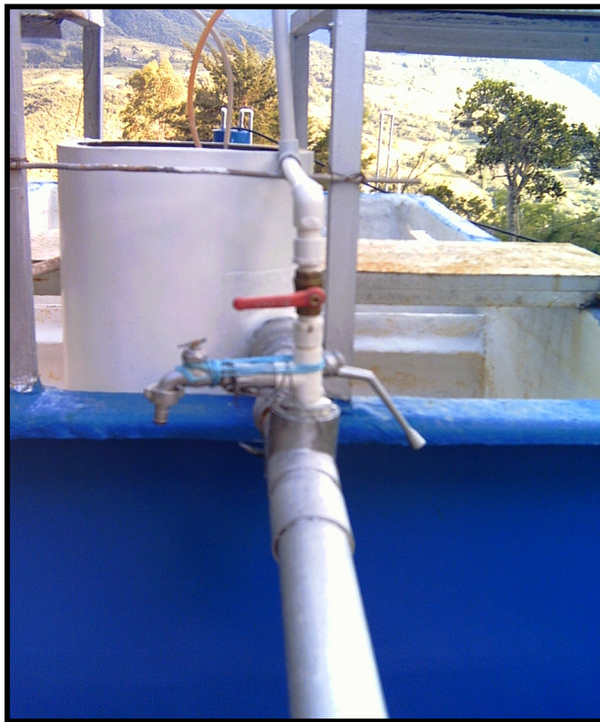
Ilustración 8. Entrada de agua en la planta
