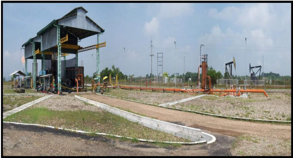
Figura 11. Estación Compresora Llanito.
