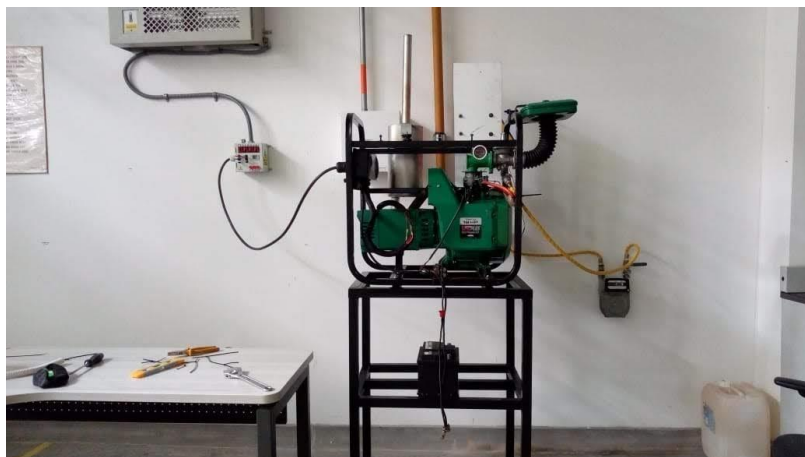
Figura 16. Grupo electrógeno que funciona a partir de gas
