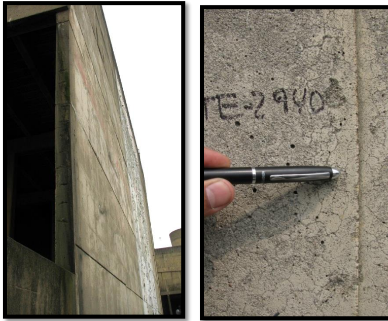
Figura 56. Fotografía deterioro de la pantalla 5 y detalle del estado del concreto de la torre TE-2940 (Fuente: el autor).
