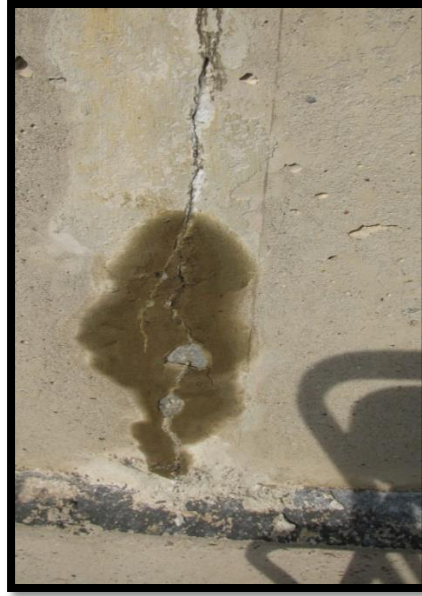
Figura 54. Fotografía de una de las grietas del costado occidental permeando, de anchos variables (0.3 a 2.0 mm) (Fuente: el autor).
