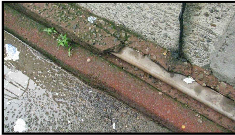
Figura 20. Fotografía detalle del estado de un sobrecimiento en el costado sur (Fuente: el autor).
