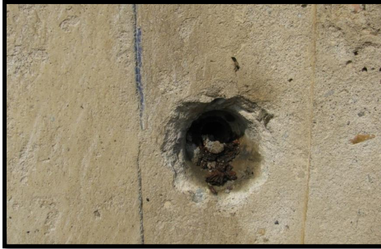
Figura 51. Fotografía detalle de la situación que se presenta en todos los muros de la TE-2940 (exceptuando los muros del tanque) (Fuente: el autor).
