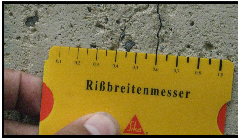
Figura 12. Fotografía detalle de la presencia de fisura localizada debajo de la escalera de espesores de 0.6 mm (Fuente: el autor).
