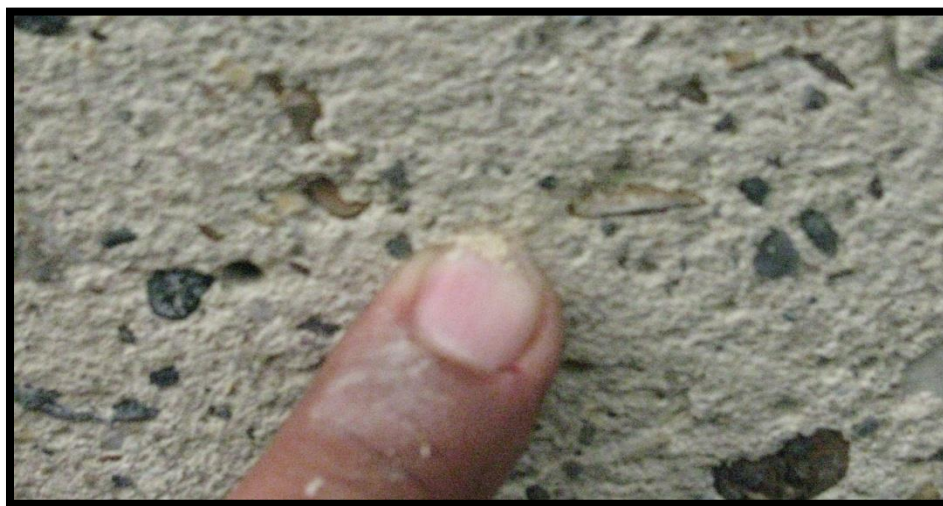
Figura 5. Fotografía detalle de la condición particular del concreto de la torre TE801-E (Fuente: el autor).
