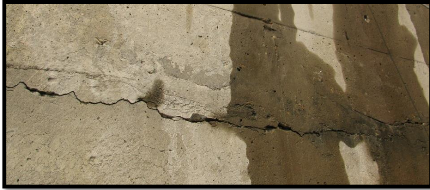
Figura 37. Fotografía detalle de la grieta (2.0-5.0 mm) en el costado sur a la altura de la viga que tiene la TE-850, sobre los extremos superiores de las columnas (Fuente: el autor).
