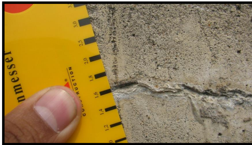
Figura 58. Fotografía detalle de medición de ancho de fisura en el muro del costado sur en la zona de la viga (Fuente: el autor).
