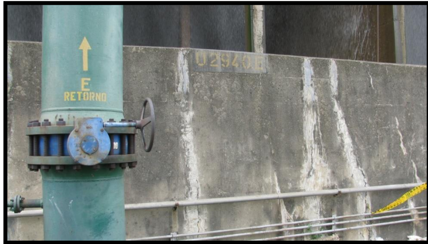
Figura 53. Fotografía detalle fisuras en el muro del tanque en el costado oriental (Fuente: el autor).
