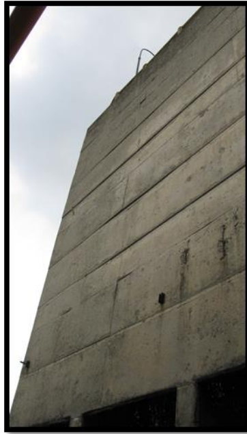
Figura 9. Fotografía detalle zonas con lesiones debidas a la corrosión del refuerzo (Fuente: el autor).
