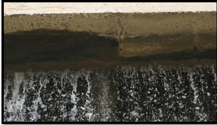
Figura 57. Fotografía detalle fisuras en la viga de borde por su cara inferior (sobre las columnas)
