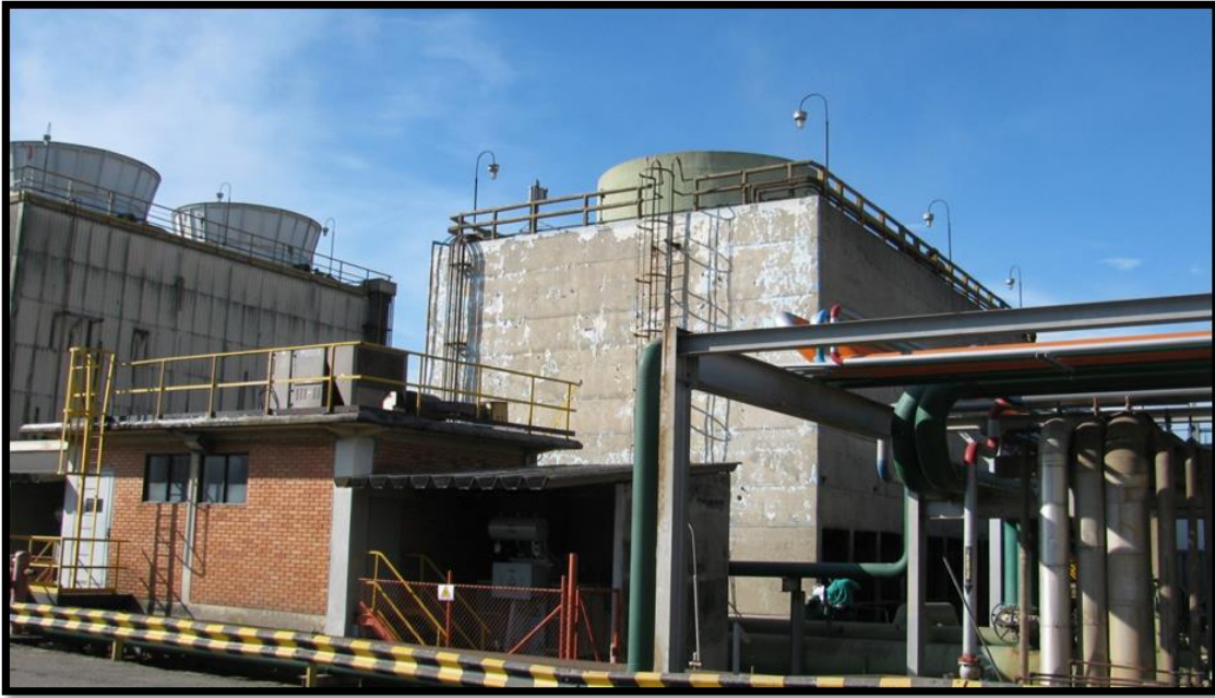
Figura 6. Fotografía vista general de la torre enfriadora TE-801E (Fuente: el autor).
