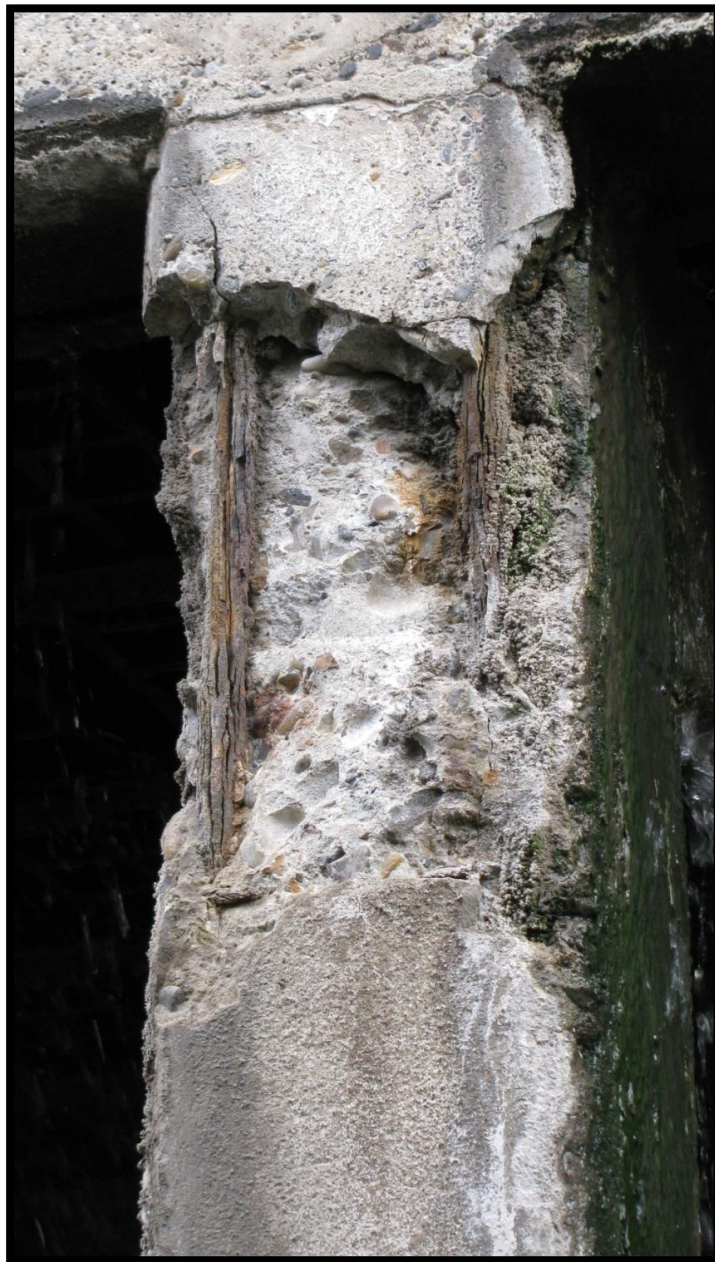
Figura 16. Fotografía detalle de las lesiones debidas a la corrosión en una de las columnas del costado occidental (Fuente: el autor).
