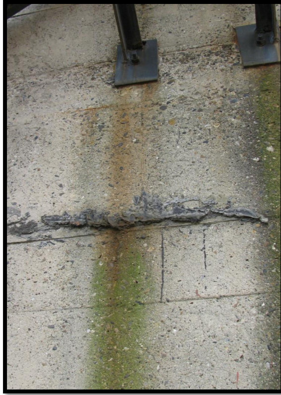
Figura 13. Fotografía detalle acumulación del producto de la permeabilidad de la junta de construcción - sobre la viga del nivel medio (Fuente: el autor).
