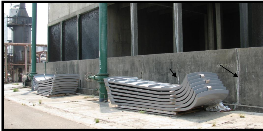
Figura 28. Fotografía detalle fisuras en el muro del tanque en el costado oriental y vista de las celdas de este mismo costado (Fuente: el autor).
