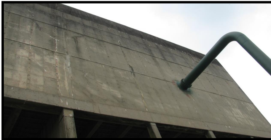
Figura 52. Fotografía grietas recurrentes que coinciden con las columnas que no se prolongaron hacia y hasta la cubierta (Fuente: el autor).
