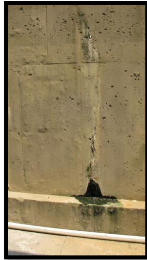
Figura 34. Fotografía detalle fisura existente en el costado occidental (Fuente: el autor).
