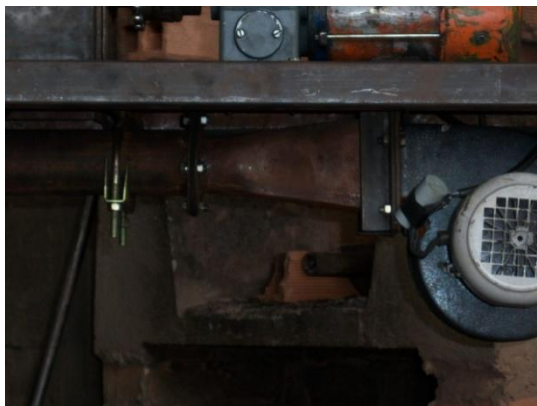
Figura 70. Ensamble del cambio de sección y quemador
