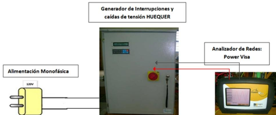
Figura C.4. Montaje de la práctica de Huecos de tensión.
