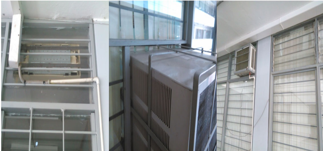
Figura 5.9: Falta de aislamiento térmico
