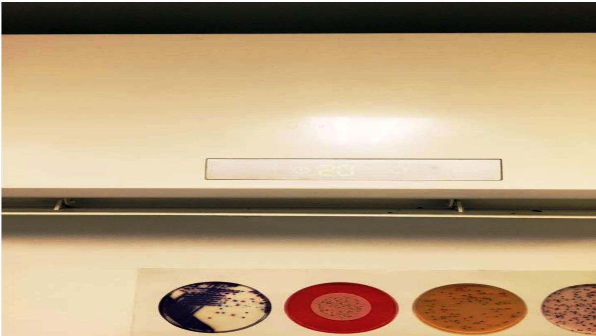
Figura 5.11: Aire acondicionado temperatura
