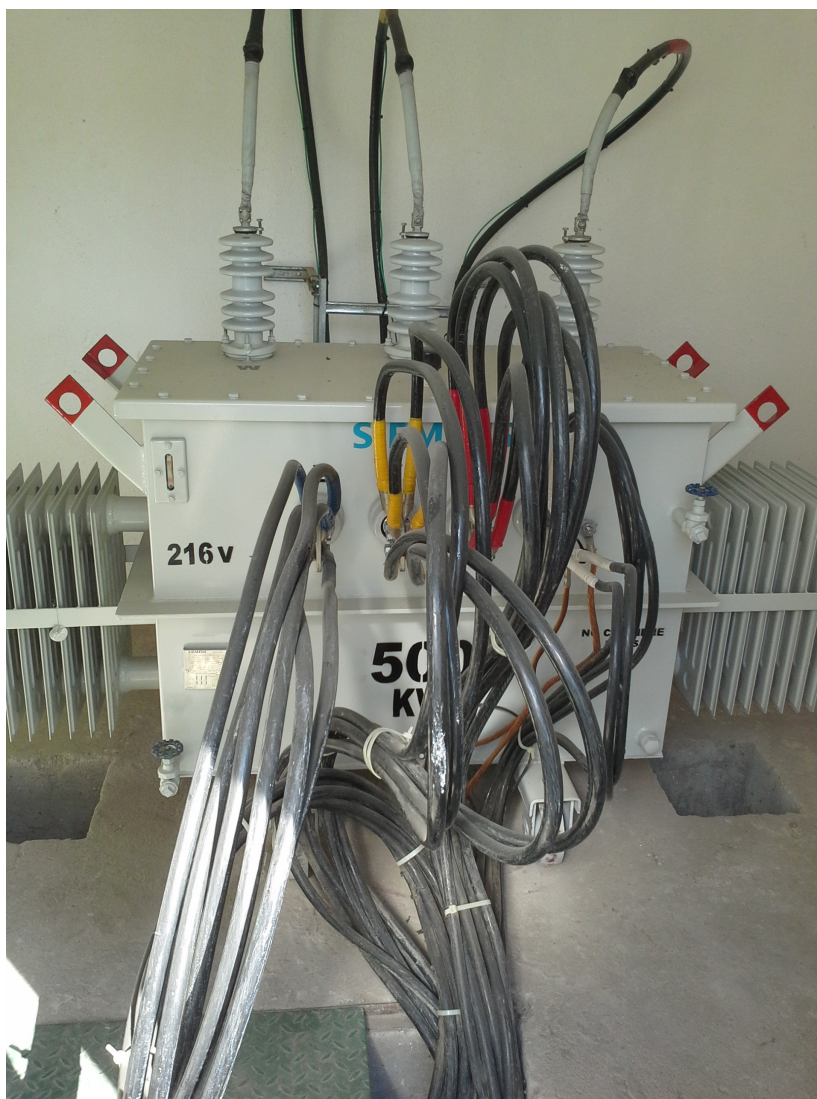
Figura 1.7: Transformador de potencia del edificio Camilo Torres
