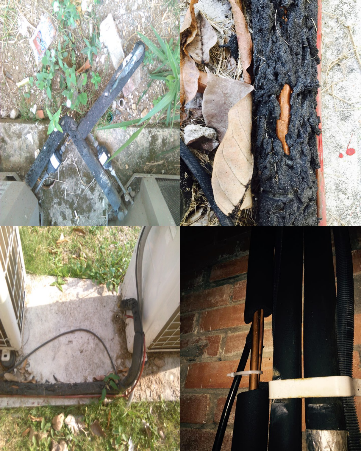
Figura 5.7: Aislamiento de ductos
