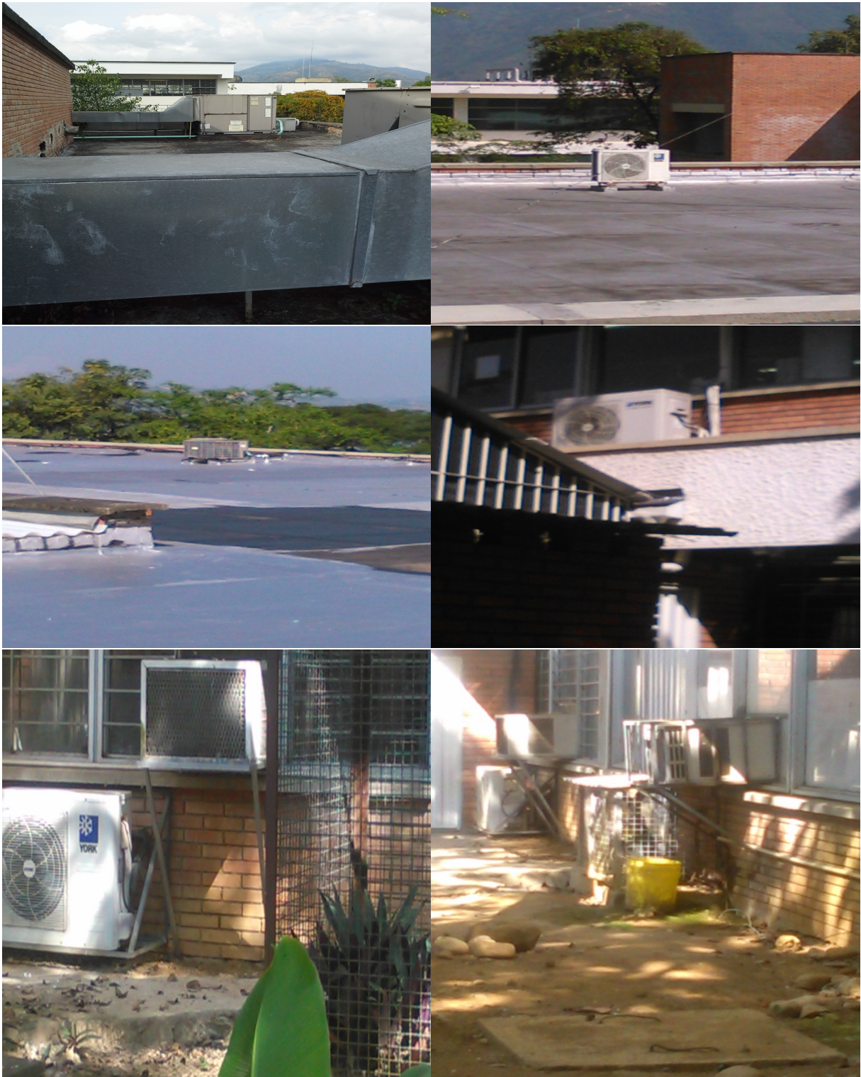
Figura 5.10: Aires acondicionados afectados por radiación solar
