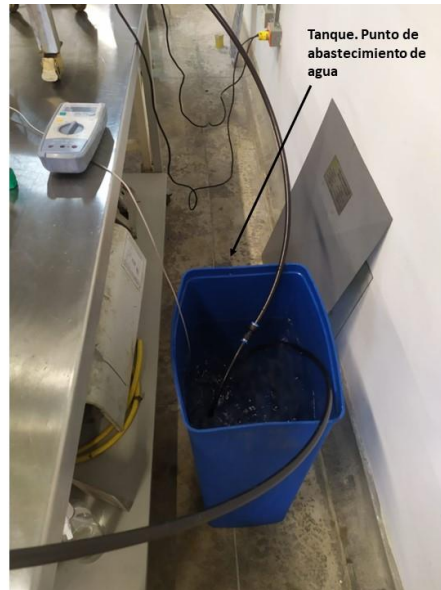
Figura D10. Tanque de abastecimiento de agua.
