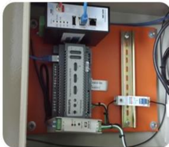
Figura 4. Tablero de control
