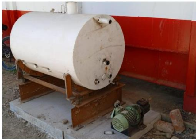
Figura 4. Tanque de combustible auxiliar y motor CEM 1 HP
