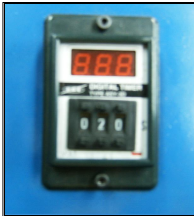
Figura 53. Detalle del temporizador asociado al circuito automático
