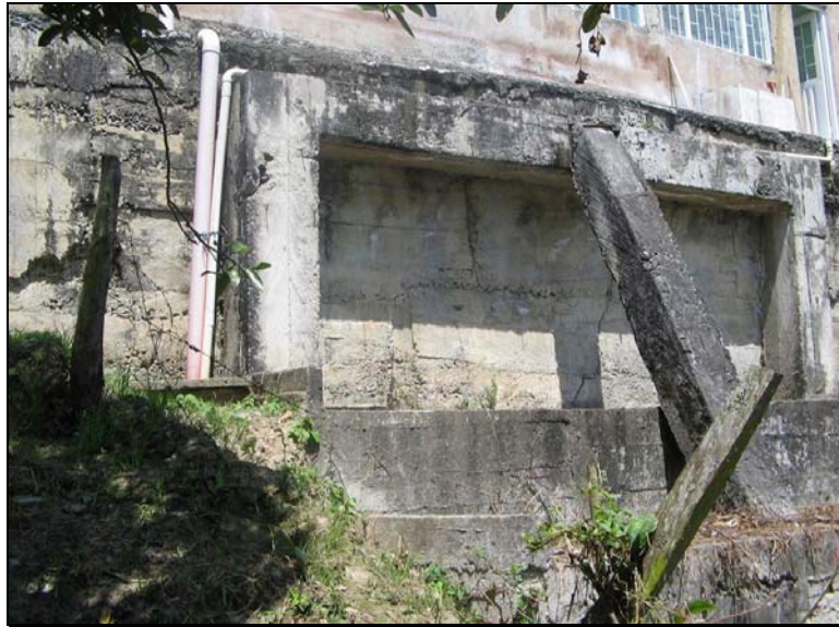
Figura 60. Obra Contención parte trasera. Centro salud Sagrado Corazón de Jesús Fuente: Investigación de los autores, 2005.
