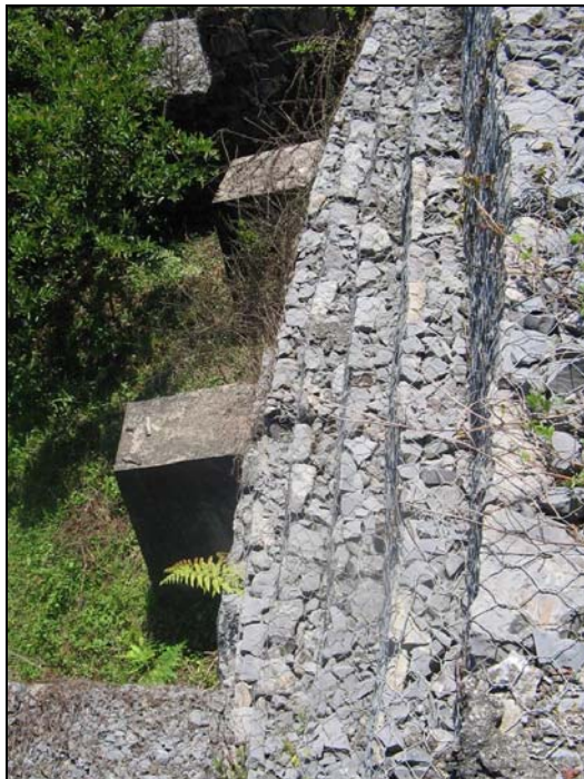
Figura 69. Muro en Gavión Cancha de Fútbol Colegio Lorenzo de Salazar. Se observa un empinamiento en el muro debido a la presión que ejercen agua y suelo.
