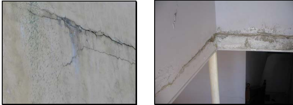
Ejemplos de muros con fisuras y grietas
