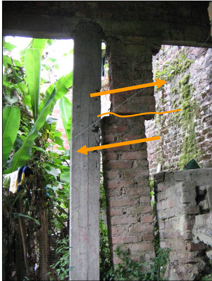
Figura 26. Daño a edificación por causa del movimiento en masa presente en el lugar.
