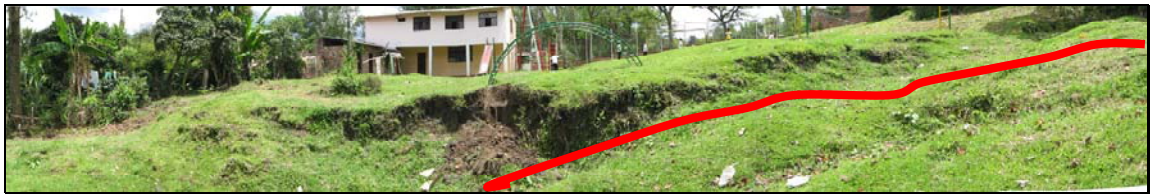
Figura 31. Vista general del movimiento presentado en el parque infantil. En rojo se aprecia la fisura que maraca el hundimiento presente en el sitio.
