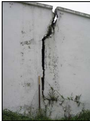
Ejemplo de muros con grietas
