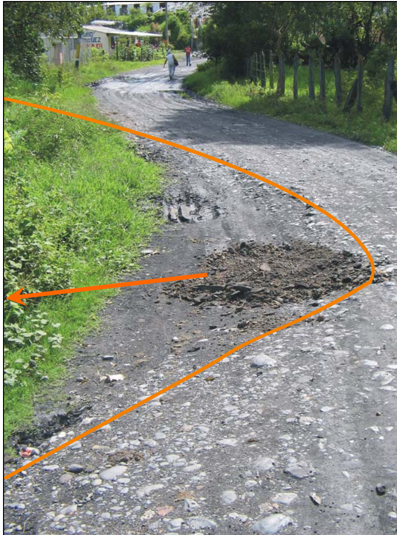
Figura 32. Movimiento de remoción en masa presente en la salida a Florián. Se observa la corona bien definida y como este afecta la vía.
