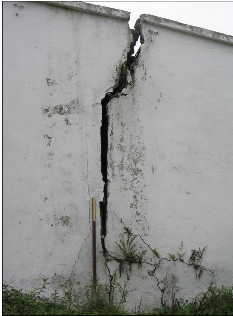
Figura 29. Fotografía del centro de salud antiguo que muestra el daño debido al fenómeno de remoción en masa presente en el sitio.
