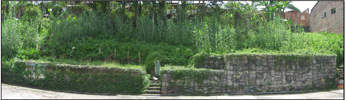
Figura 66. Muro en Gavión y filtros subterráneos. Sector Casa de la Cultura Fuente: Investigación de los autores, 2005.
