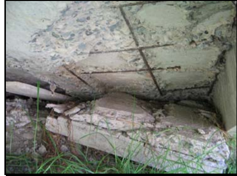
Ejemplos de pisos con asentamientos
