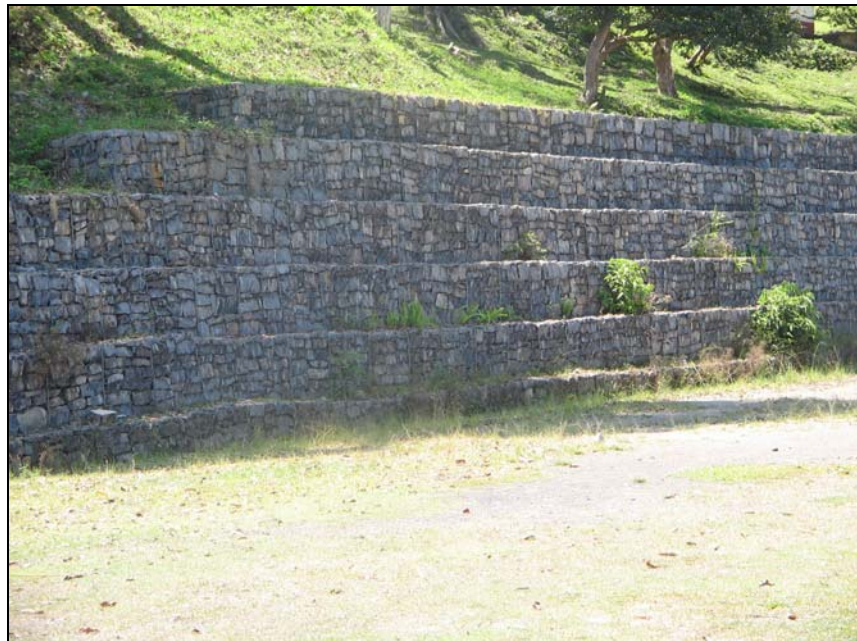
Figura 22. Vista general del FRM presente en la parte Norte del Colegio Lorenzo de Salazar.
