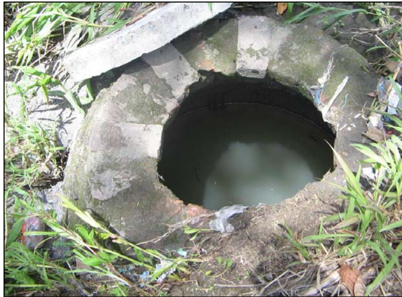
Figura 72. Problemas en pozos antes de verter sus aguas libremente hacia el chorro Tequendama. Sector Los Pinos detrás del antiguo botadero de basuras Fuente: Investigación de los autores, 2005
