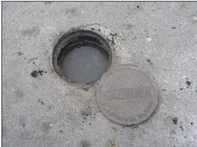
Figura 74. Estado de algunas válvulas las redes de acueducto ubicadas en el sector de la Muralla, Zona urbana Jesús María.
