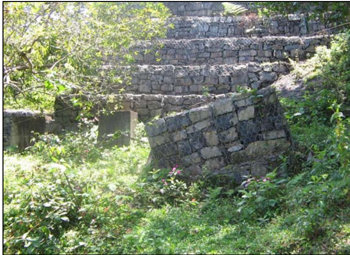
Figura 68. Muro en Gavión Cancha de Fútbol Colegio Lorenzo de Salazar. Se observa que cede por la presión del suelo y el agua.
