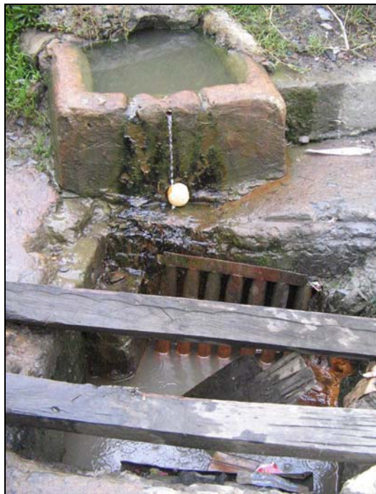
Figura 76. Aguas de fuentes naturales sin control, Sector A, Barrio La Bomba.
