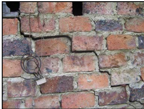
Falla presentada en muros de mampostería
