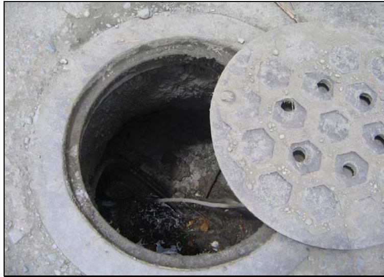
Figura 75 Estado de algunos pozos de las redes de alcantarillado los cuales sobre los cuales no hay un mantenimiento para permitir el paso del agua lluvia y permanecen taponados.
