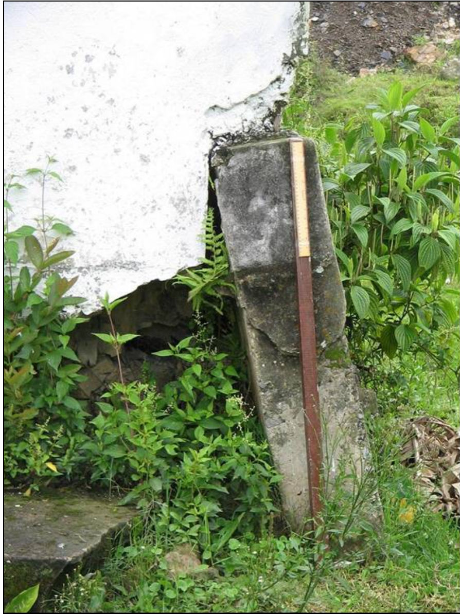
Figura 30. Fotografía que muestra el daño al antiguo hospital debido al fenómeno de remoción en masa presente en el sitio.
