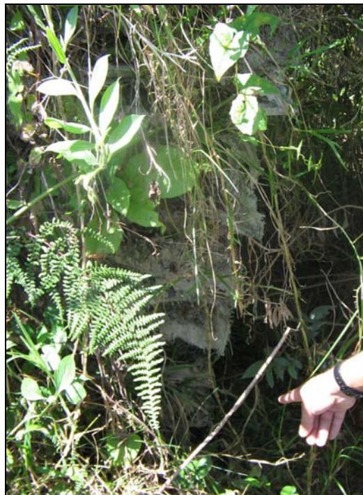
Figura 61. Muro Costales costado noreste cancha fútbol Colegio Lorenzo de Salazar Fuente: Investigación de los autores, 2005.
