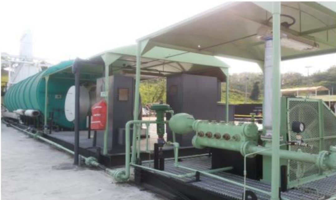
Figura 9. Generador de vapor
