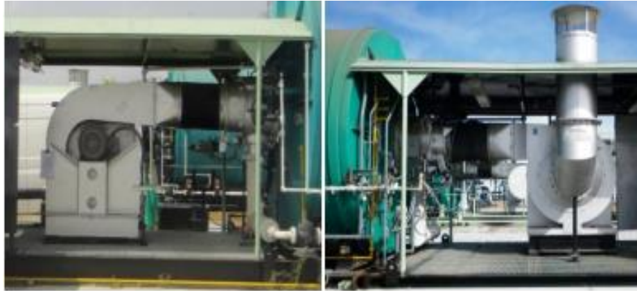
Figura 10. Quemador del generador de vapor.
