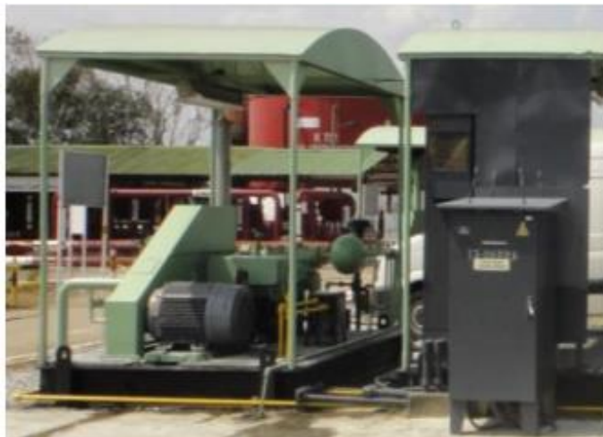
Figura 11. Bomba de alimentación del generador de vapor.
