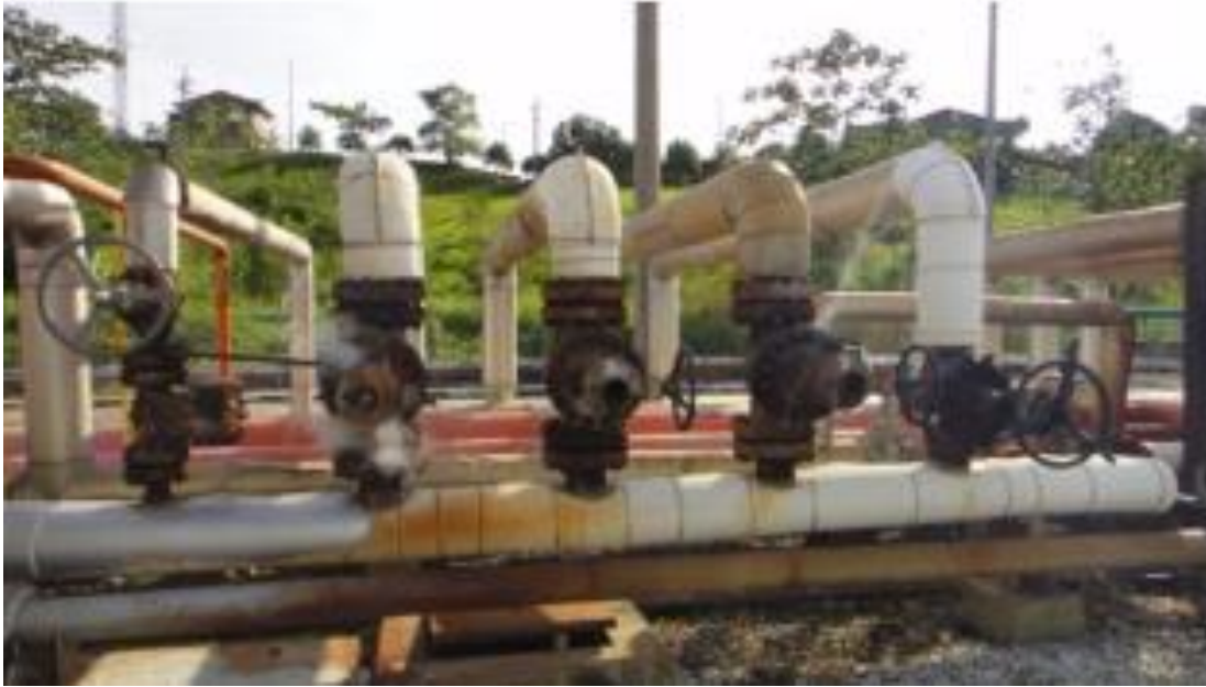
Figura 12. Manifold de Inyección de vapor.
