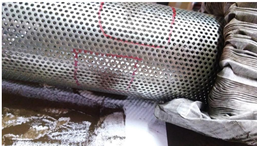
Figura 8. Detalle de corrosión localizada en la malla metálica que protege el elemento filtrante, de las áreas corroídas se tomó la muestra número 3.
