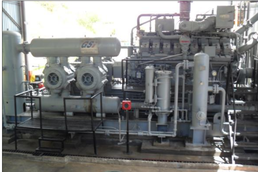
Figura 20. Compresor de gas lift N° 1 campo Rio Ceibas
