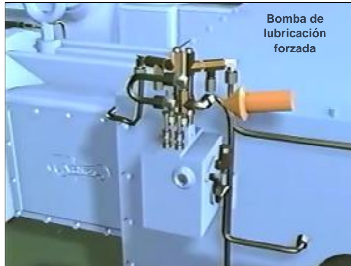
Figura 21. Bomba de lubricación forzada del compresor
