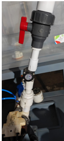
Figura 8 Válvulas de succión descarga y sensor de caudal
