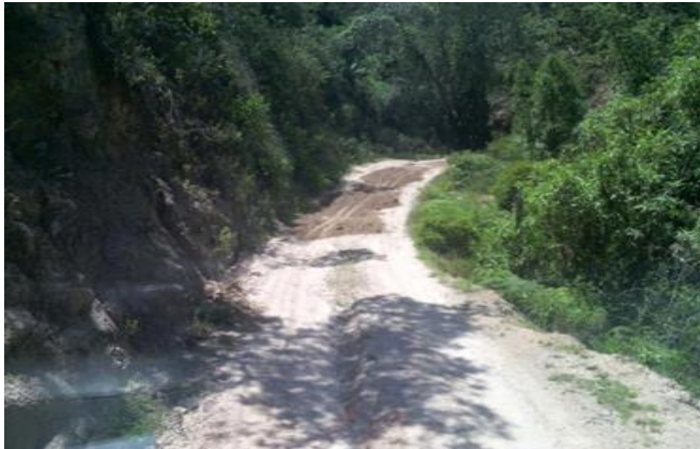
Figura 11. Limpieza de escombros (derrumbes) y mantenimiento rutinario en Cepita – Bucaramanga (11 km). Fuente: Autor
