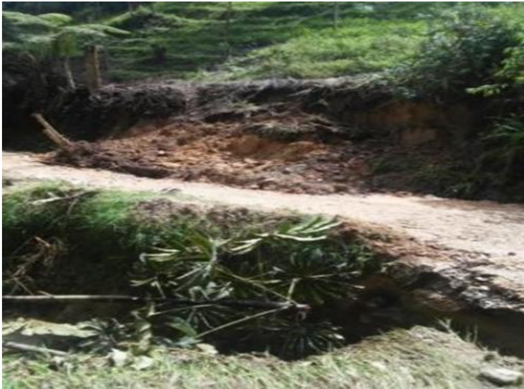
Figura 14. Piedecuesta comodato 853 2016. Remoción de derrumbes y adecuación de la vía. Vereda Meseta Grande: 3km. Fuente: Autor
