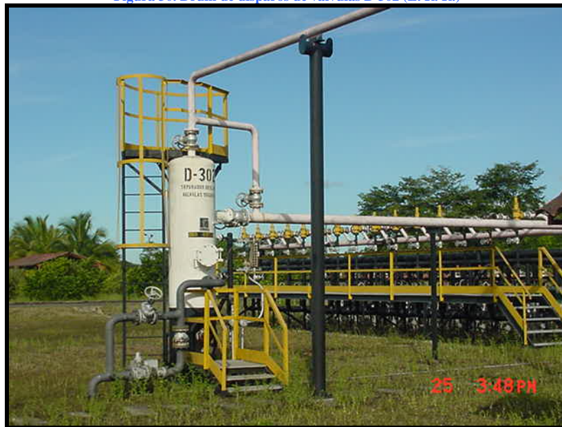
Figura 30. Drum de disparos de válvulas D 302 (E. R. R.)
