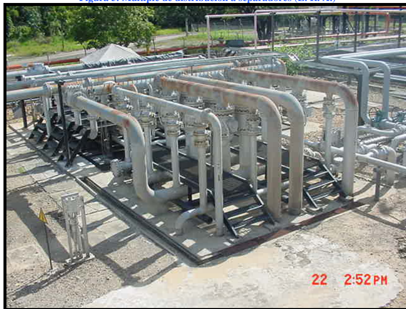
Figura 5. Múltiple de distribución a separadores (E. R. A.)
