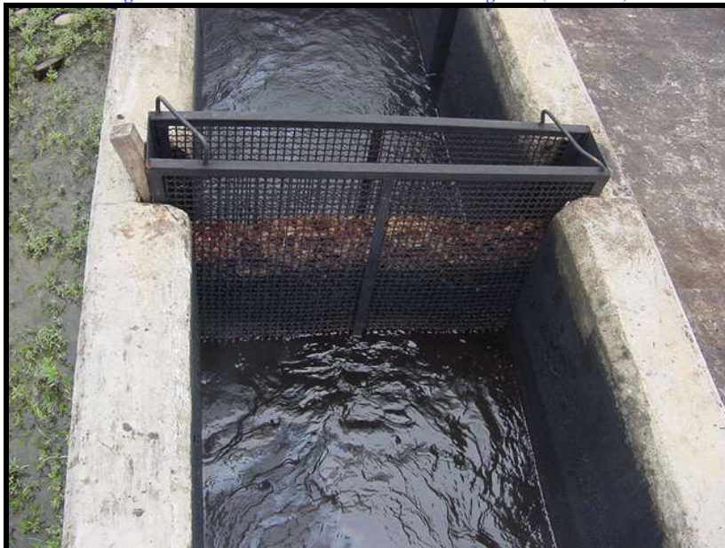
Figura 49. Canales con filtros de eliminación de grasas (E. R. CH.)
