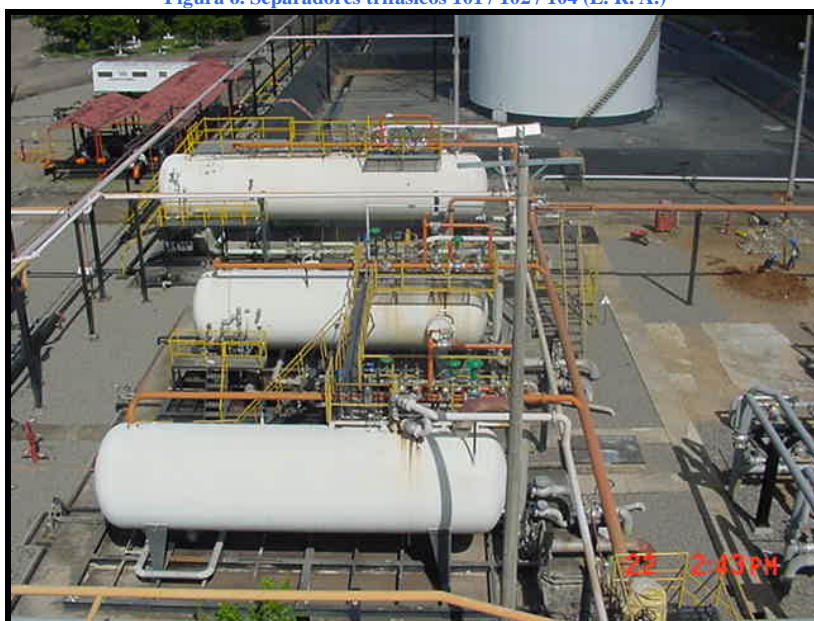
Figura 6. Separadores trifásicos 101 / 102 / 104 (E. R. A.)
