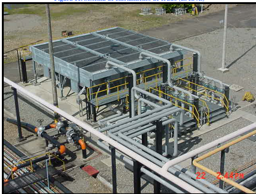
Figura 11. Sistema de enfriamiento de crudo (E. R. A.)
