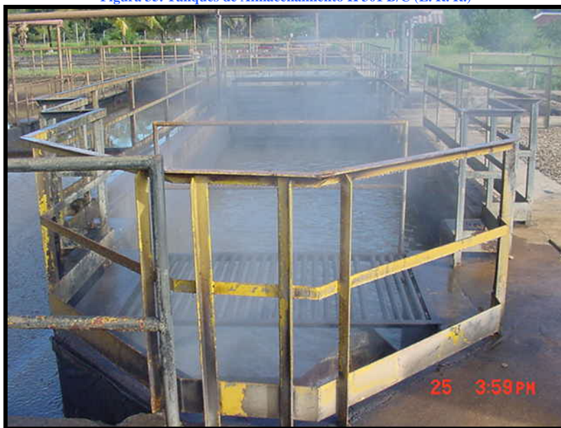
Figura 35. Tanques de Almacenamiento K 301 B/C (E. R. R.)
