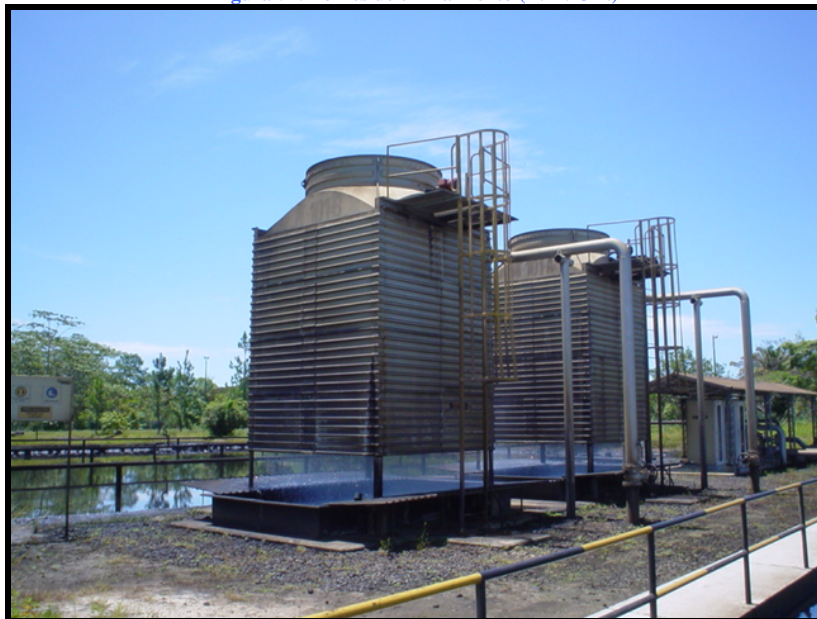
Figura 52. Torres de enfriamiento (E. R. CH.)
