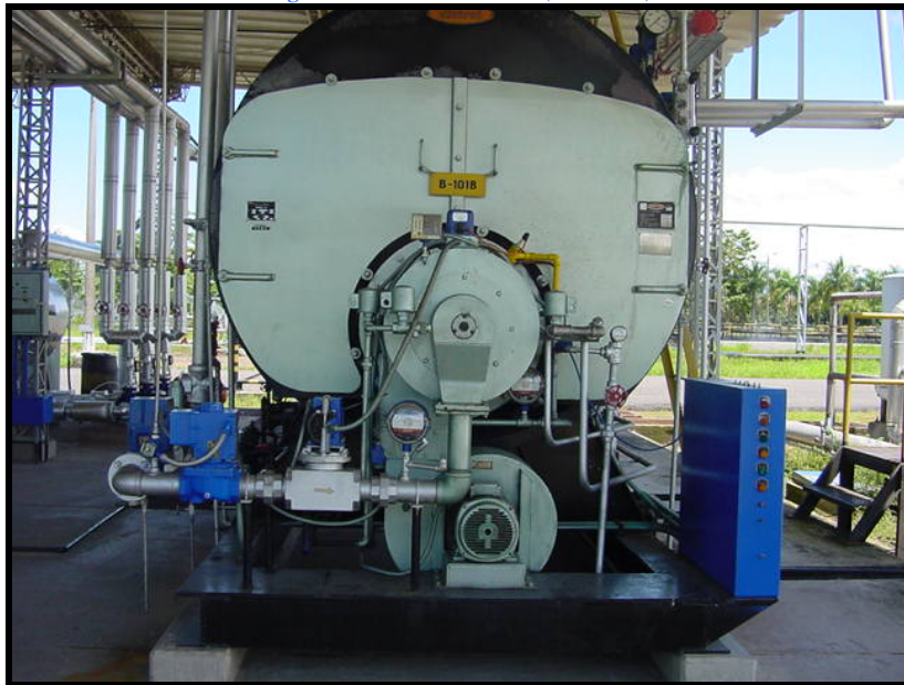
Figura 42. Caldera B-101 B (E. R. CH.)
