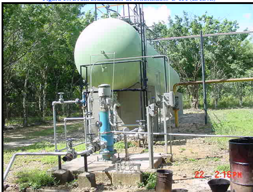
Figura 10. Drum acumulador de condensados D-151 (E. R. A.)
