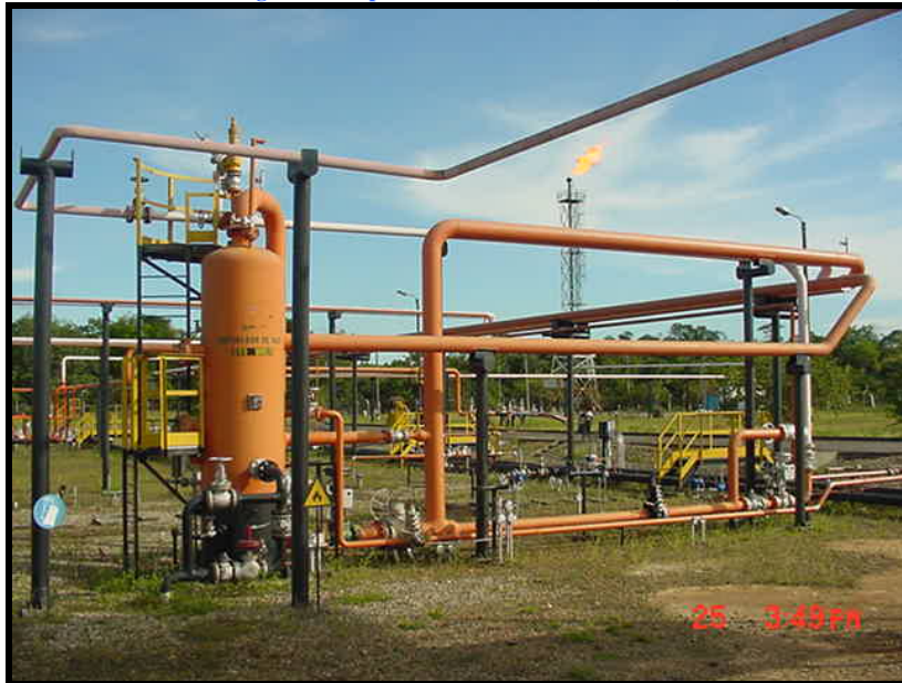
Figura 29. Depurador de Gas D 305 (E. R. R.)
