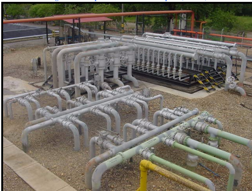
Figura 12. Múltiples de distribución a tanques 9 (E. R. A.)
