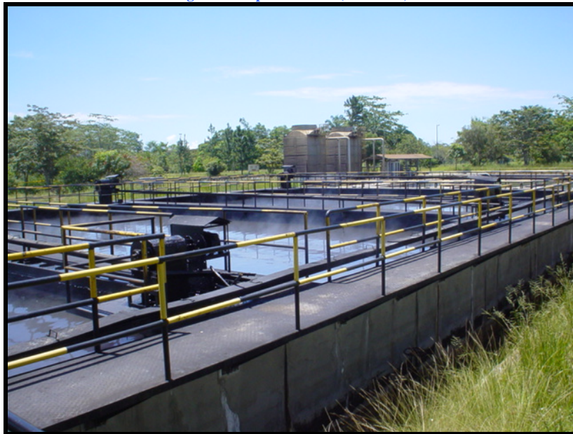
Figura 47. Separador API (E. R. CH.)
