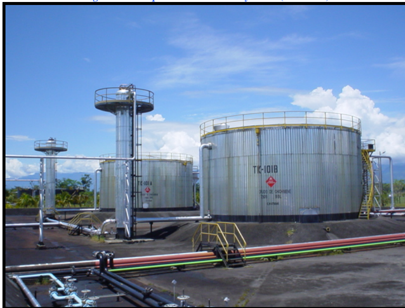
Figura 44. Tanques de lavado 101 A y 101 B (E. R. CH.)
