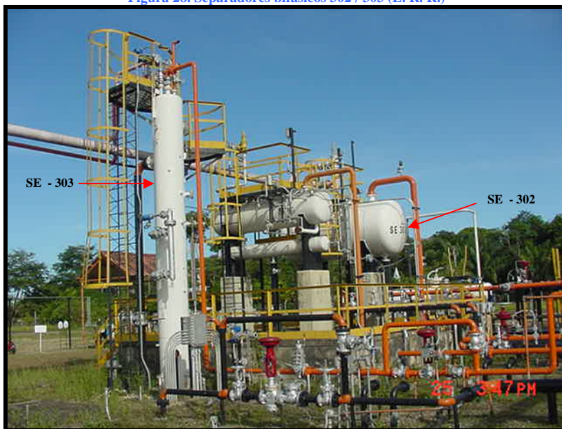
Figura 28. Separadores bifásicos 302 / 303 (E. R. R.)
