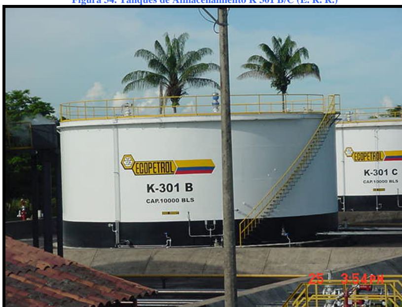
Figura 34. Tanques de Almacenamiento K 301 B/C (E. R. R.)
