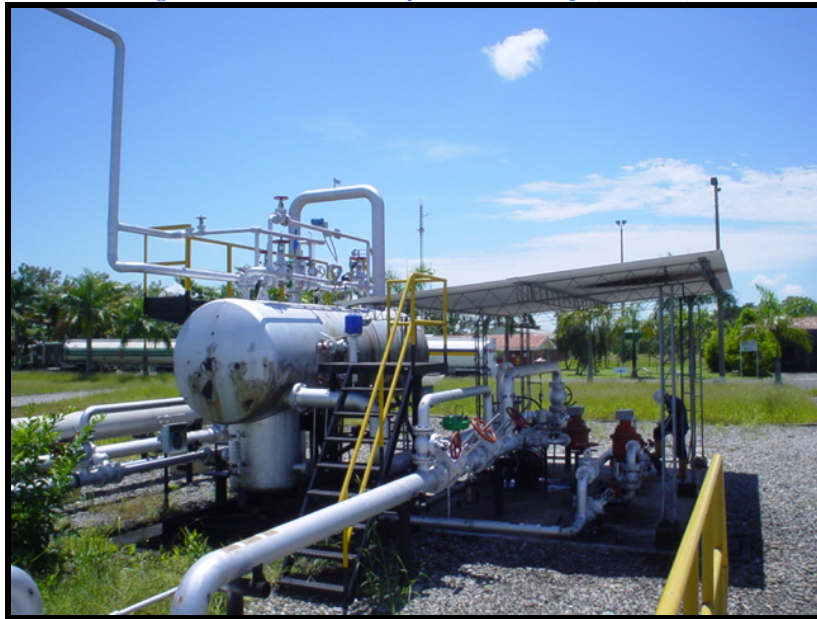
Figura 45. Tambor de Prueba y medidores de flujo (E. R. CH.)
