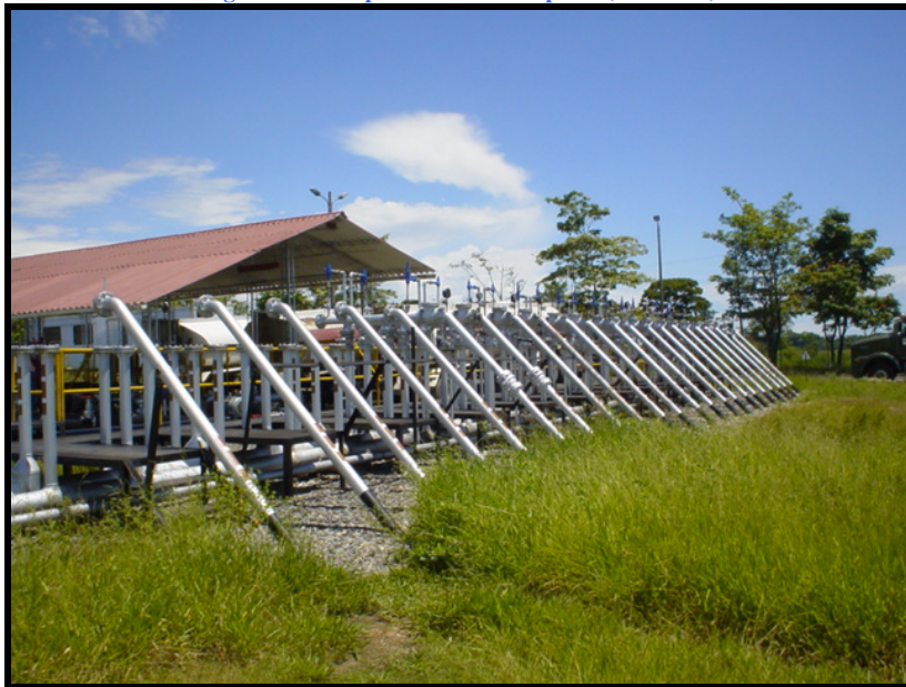
Figura 39. Múltiple de Entrada de pozos (E. R. CH.)
