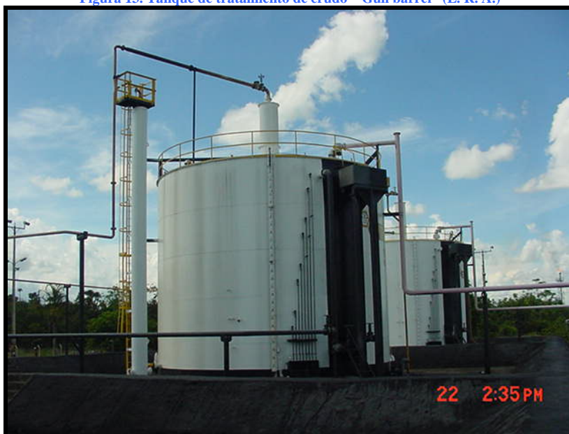
Figura 13. Tanque de tratamiento de crudo "Gun barrel" (E. R. A.)
