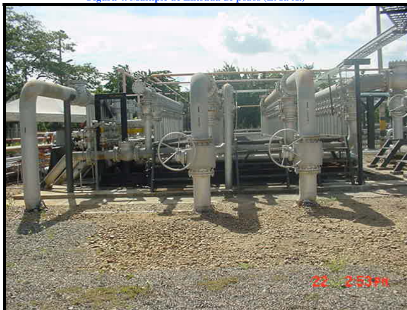
Figura 4. Múltiple de Entrada de pozos (E. R. A.)
