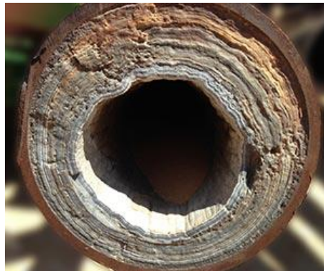
Figura 1. Tubería bloqueada por escamas de sulfato de bario. Recuperado de: https://bit.ly/2FVg0zc
