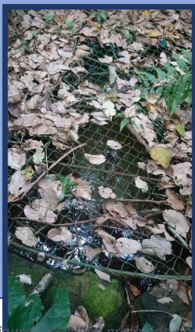
Figura 123 Aljibe protegido por una reja metálica
