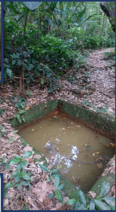
Figura 120 Aljibe sin protección
