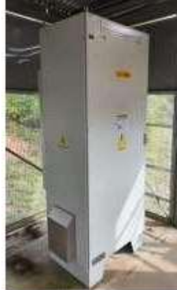
Ilustración 2 Variador de frecuencia (VSD)
