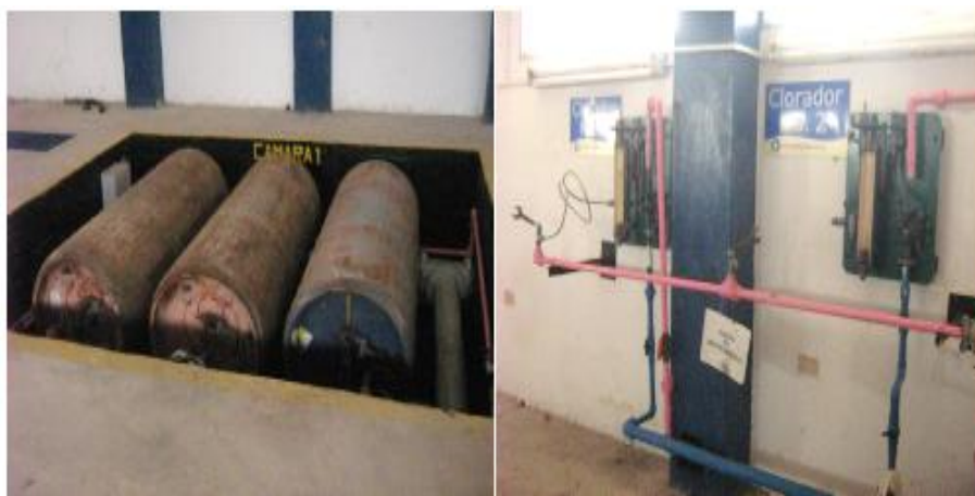
Figura 32. Cilindros y clorador.
