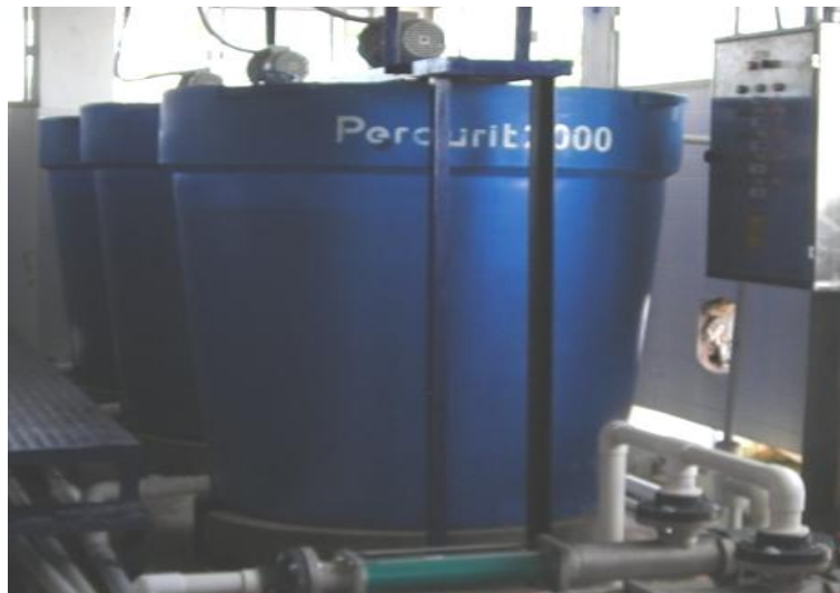
Figura 18. Tanques dosificación Pre oxidante y polímero
