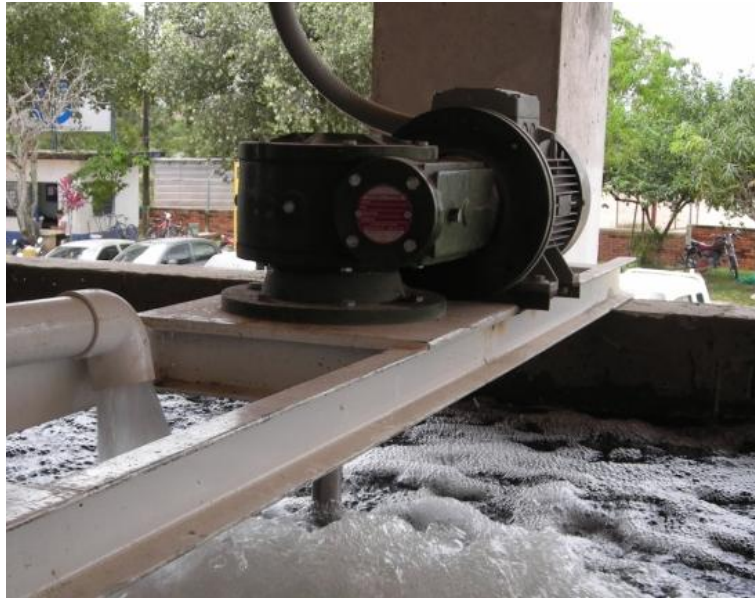
Figura 14. Sistema de agitación tanques de dilución y tanque de dosificación
