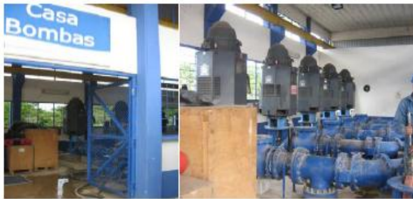
Figura 35. Estación de bombeo de agua potable
