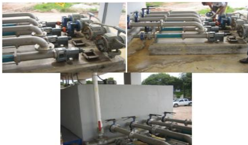
Figura 15. Bombas dosificadoras de sulfato de aluminio.
