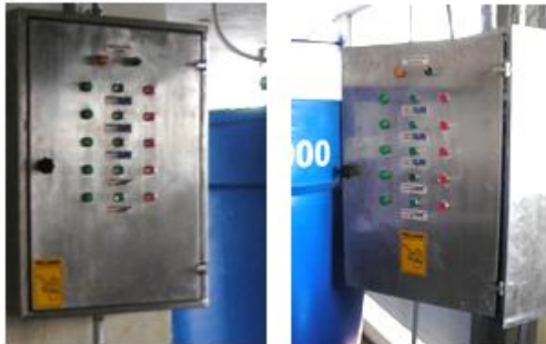
Figura 21. Tableros de control eléctrico Pre oxidante y polímero
