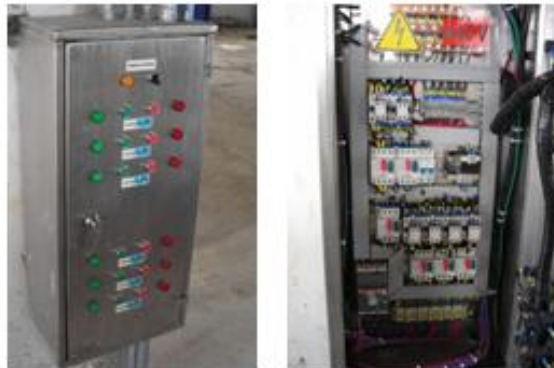
Figura 16. Tableros de control bombas dosificadoras sulfato de aluminio
