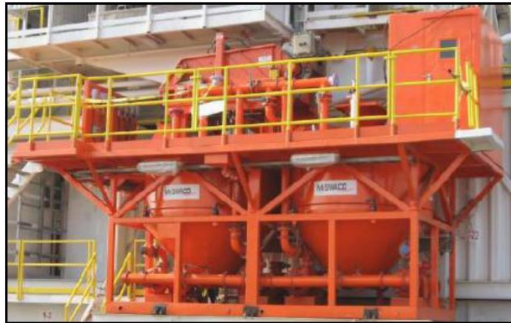
Figura 8. Tanques secundario y de preparación
