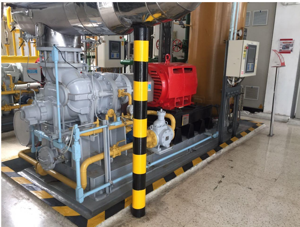
Figura 17. Área de servicios industriales, sector de refrigeración
