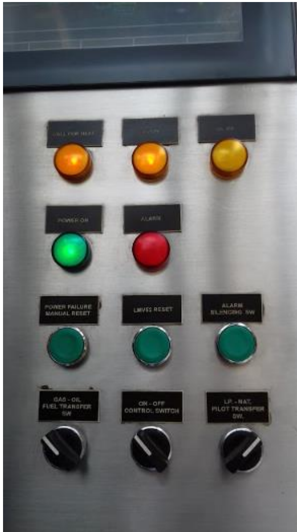
Figura 32. Subsistema de control y potencia.
