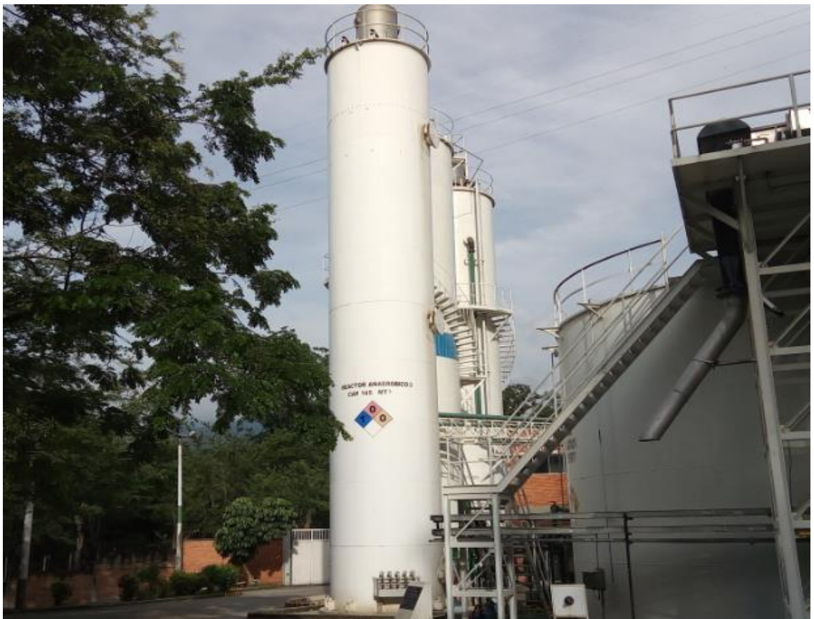
Figura 12. Planta de tratamiento de aguas residuales.
