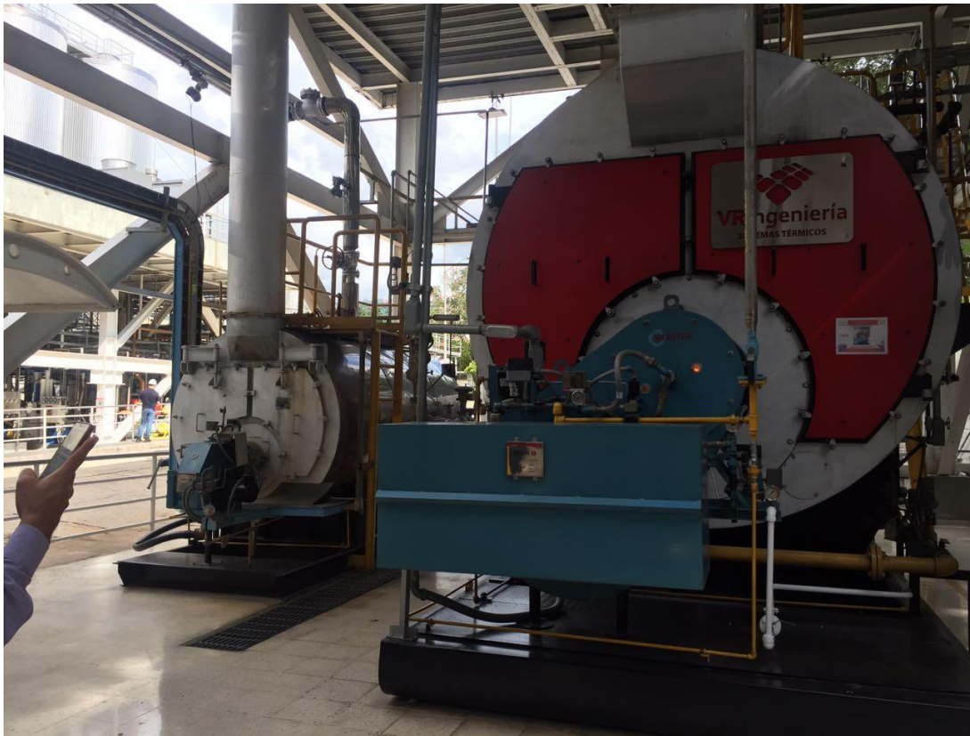
Figura 16. Área de servicios industriales, sector de calderas.
