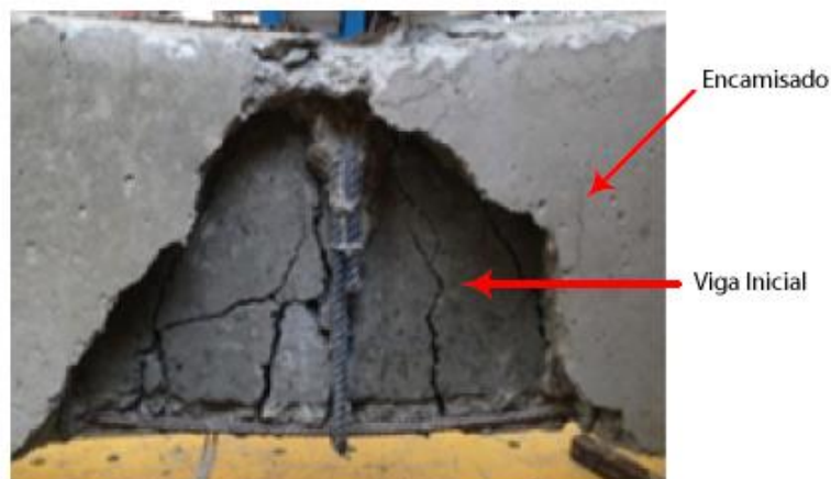
Figura 37. Formación de fisuras en la parte central de la viga inicial que fue encamisada. Nota: Adaptado de Tahsiri, Sedehi, Khaloo, & Raisi, 2015
