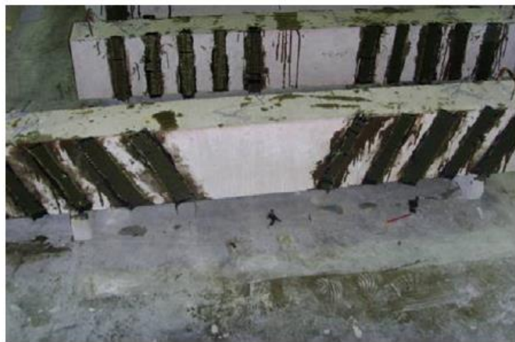
Figura 54. Vigas reforzadas con tiras de CFRP vertical e inclinado
