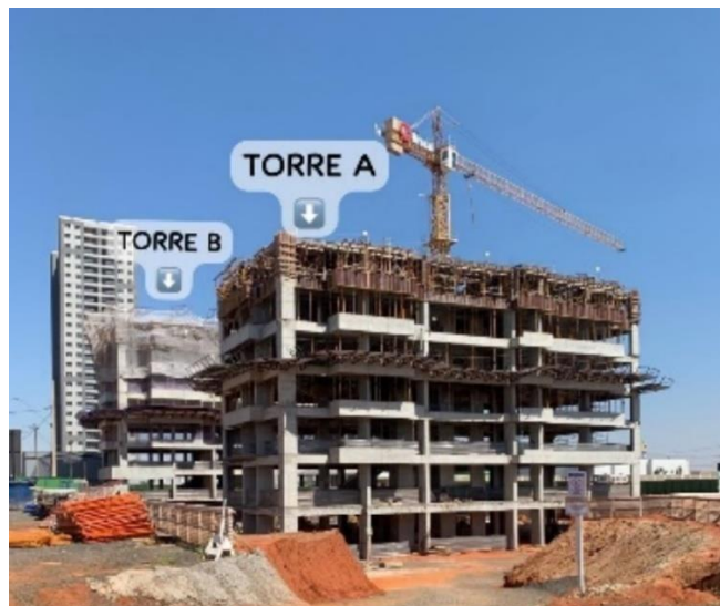
Figura 3. Estado de la estructura al inicio de la práctica empresarial
