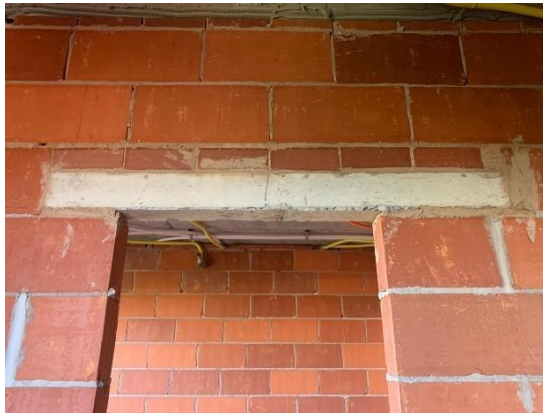
Figura 18. Mampostería no estrutural
