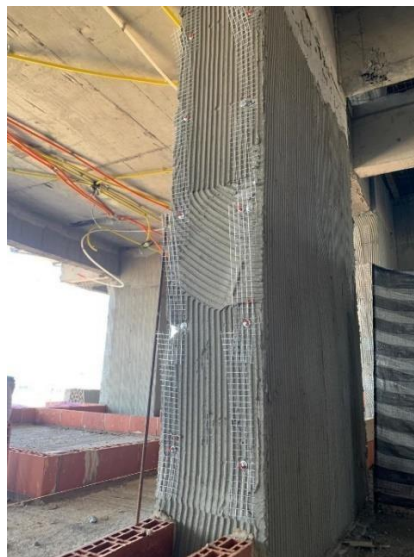
Figura 15. Mortero de agarre y mechas de anclaje en elementos estructurales
