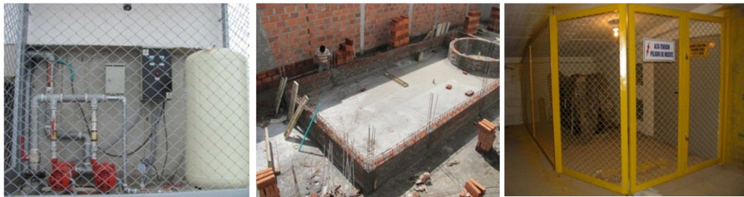
Figura 25. Cuarto de bombas y planta eléctrica
