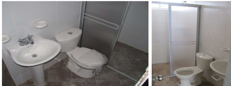
Figura 24. Carpintería de aluminio y aparatos sanitarios
