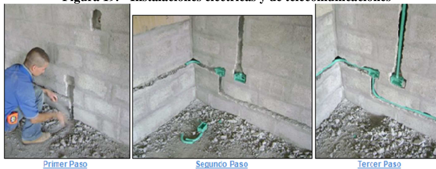
Figura 19. Instalaciones eléctricas y de telecomunicaciones
