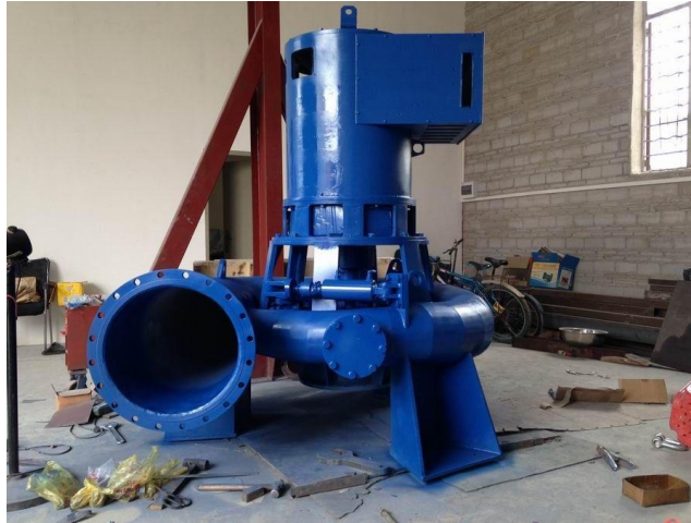
Figura 9. Turbina Francis acoplada a un generador de 250KW
