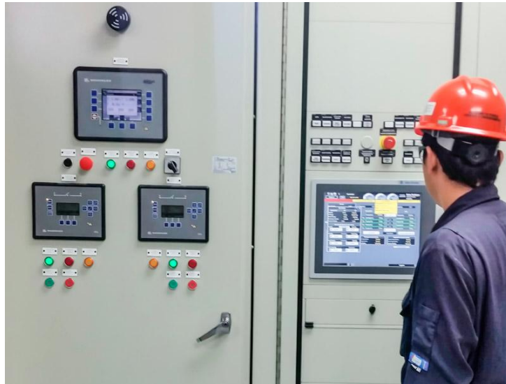
Figura 49. Tablero de control en generación hidroeléctrica
