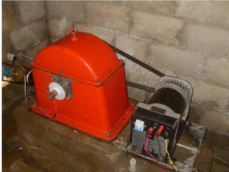
Figura 7. Equipo electromecánico en picocentral hidroeléctrica de 5 KW
