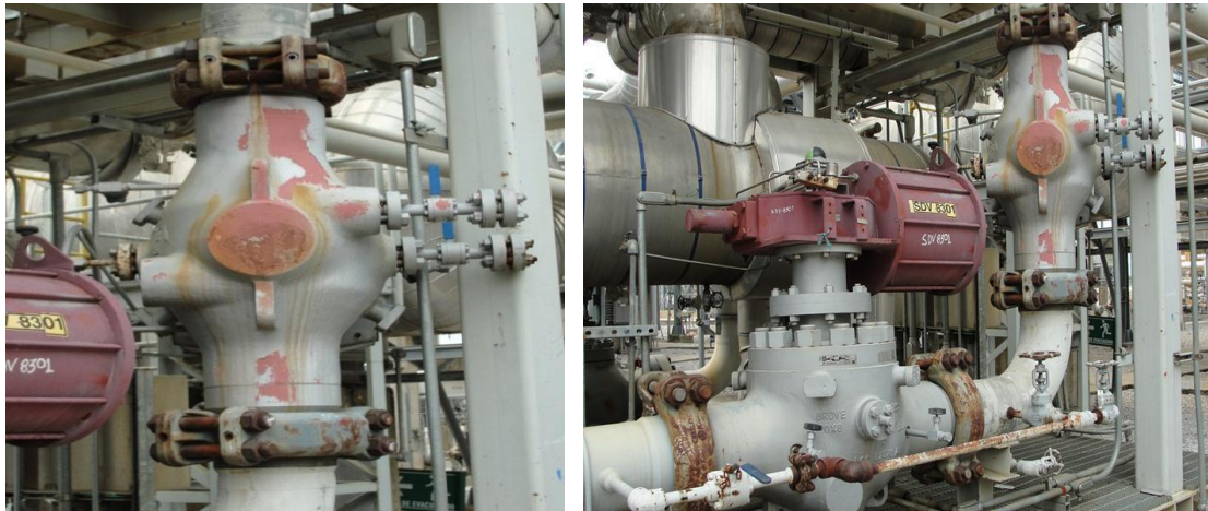
Figura 20. Registro fotográfico de nueva válvula de aislamiento en la unidad de Dew Point, que garantizan doble bloqueo y purga.
