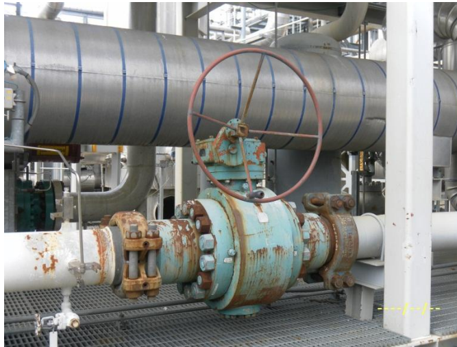
Figura 12. Registro fotográfico de valvula de bloqueo y drenaje en la unidad de Dew Point # 1.
