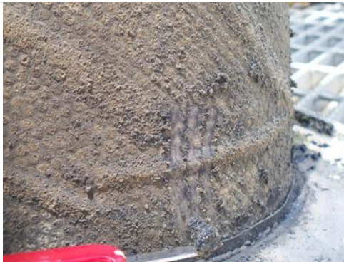
Figura 8. Registro fotográfico del estado del filtro de succión luego de presentar trip de la unidad por alta presión diferencial
