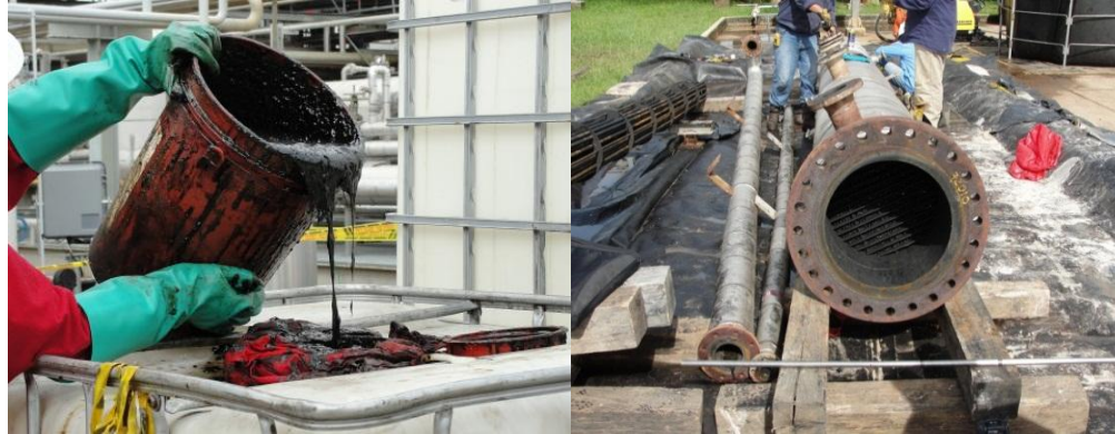
Figura 11. Registro fotográfico de fluido viscoso drenado en la unidad regeneradora de Glicol, inspección torre de stripping de la unidad regeneradora
