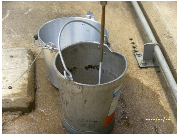
Figura 18. Registro fotográfico de drenaje de condensado y glicol en la línea de descarga del turboexpander #1, planta de gas Cusiana
