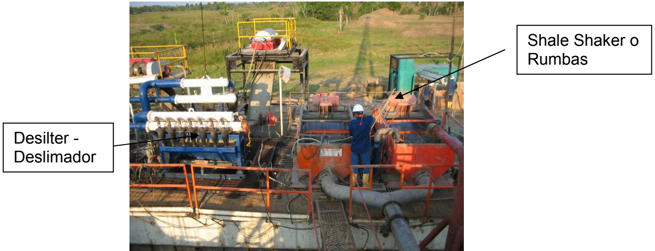
Figura 11. Equipo de Control de sólidos.
