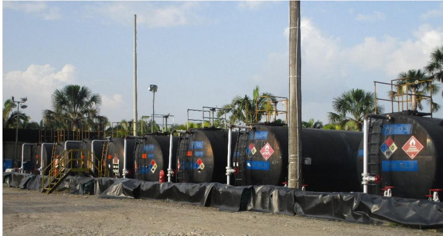
Figura 24. Tren de tanques horizontales para almacenamiento de crudo tipo cigarro.
