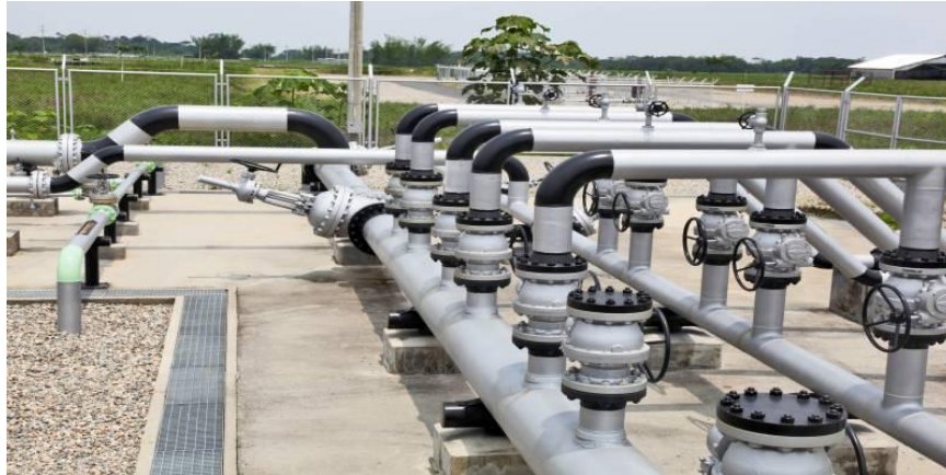
Figura 11. Múltiple de recibo. Maco Ingeniería. Servicios mecánicos. Villavicencio. 2019 Tomada de https://macoingenieria.com/Mecanicas.html
