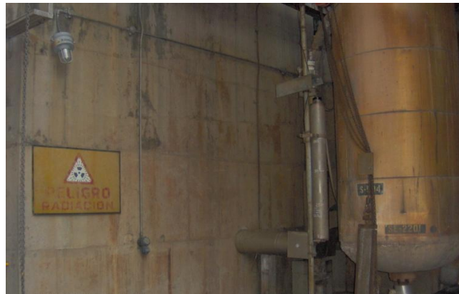
Figura 3. Fuentes para medición de nivel, al interior del tanque utilizada en Polietileno
