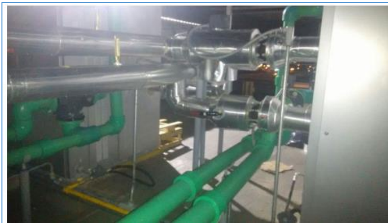
Figura 36. Conexión de chiller con tubería de polipropileno.
