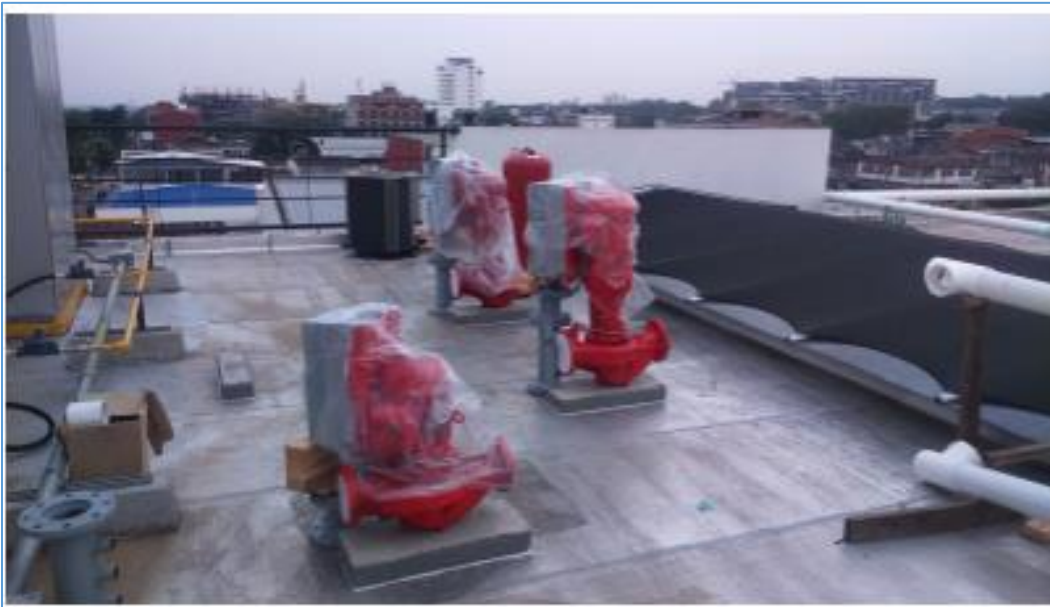
Figura 33. Conexiones bombas de agua helada y de torre de enfriamiento
