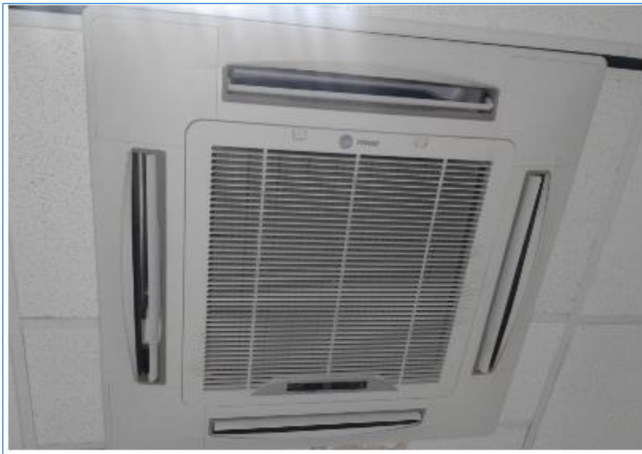
Figura 38. Fancoil tipo cassette instalado.
