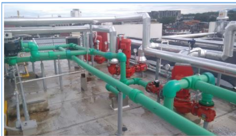
Figura 37. Tubería de polipropileno para conexión chiller torre de enfriamiento
