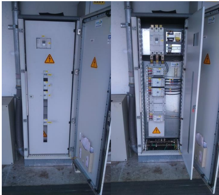
Figura 23. Tablero de distribución 480 VAC – cubierta.
