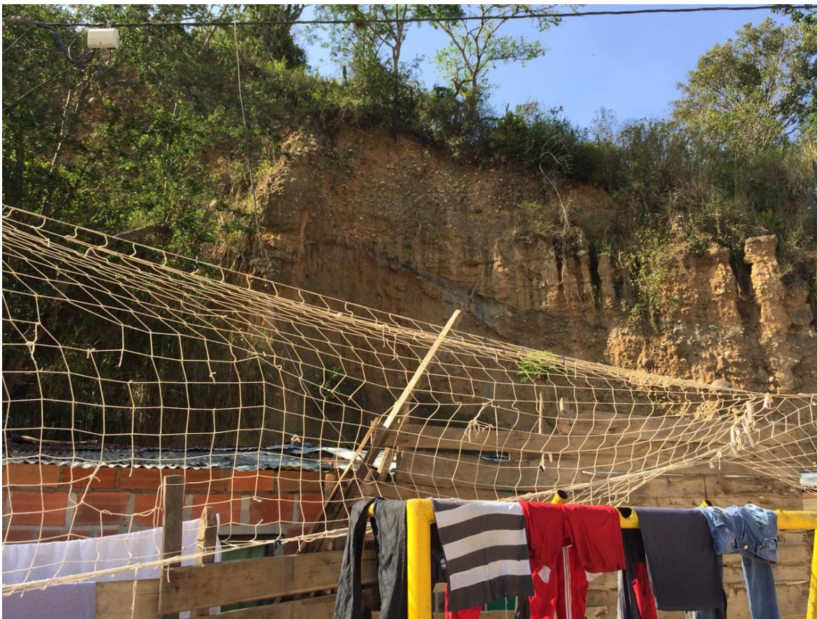
FIGURA 98. Cambuches ubicados en zona de alto riesgo.
