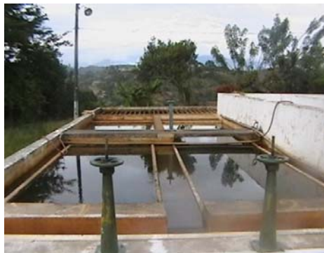
Figura 2.5. Sedimentadores de la planta del municipio de Lebrija.
