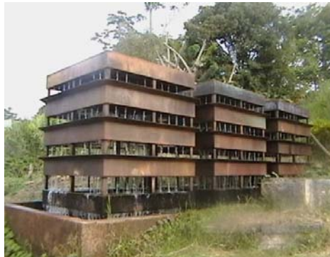
Figura 2.1. Cámara de aireación en la planta del municipio de Lebrija.
