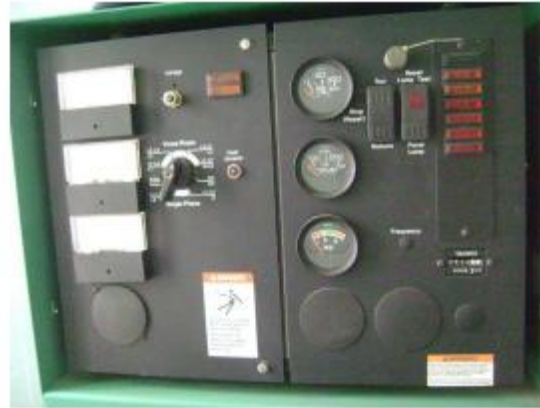
Figura 2.10 Modulo de control de la planta de Administración_1
