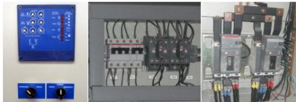
Figura 2.7 Unidad de transferencia de la planta del CENTIC
