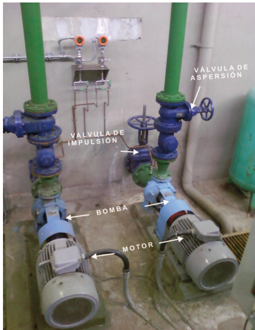
Figura 1.5: Central de Refrigeración
