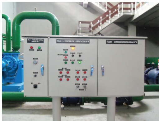
Figura 1.7: Tablero de mando local incluyendo TL, TCLU y TCOM
