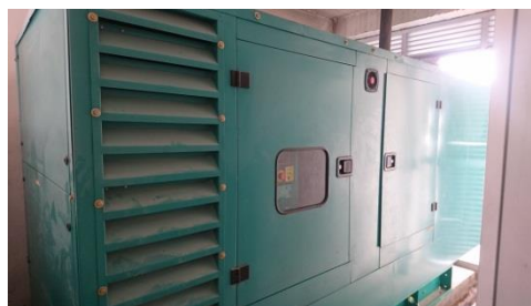
Figura 11: vista lateral de Planta eléctrica
