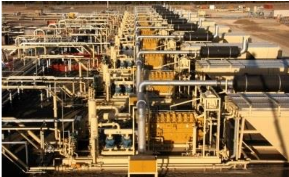
Figura 7. Unidades de compresión de gas natural tipo reciprocantes.
