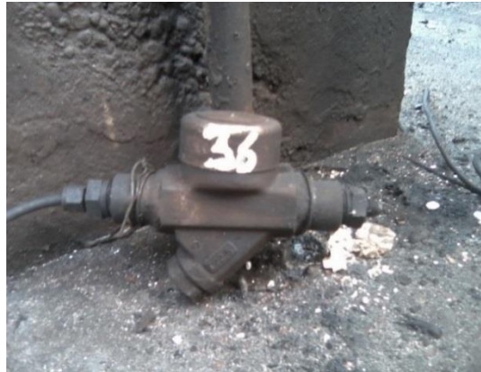
Figura 3. Identificación de trampas de vapor mediante marcador industrial.
