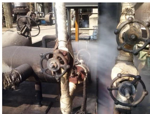
Figura 6. Escape de vapor por válvula en la unidad U-2100.
