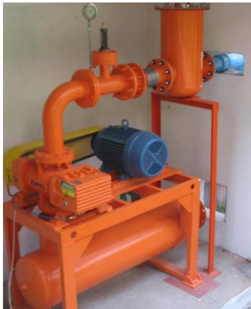
Figura 41. Soplador de 20 hp de potencia para generación de vacío
