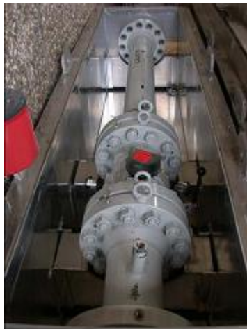
Dispositivo de transferencia (dos Turbinas)
